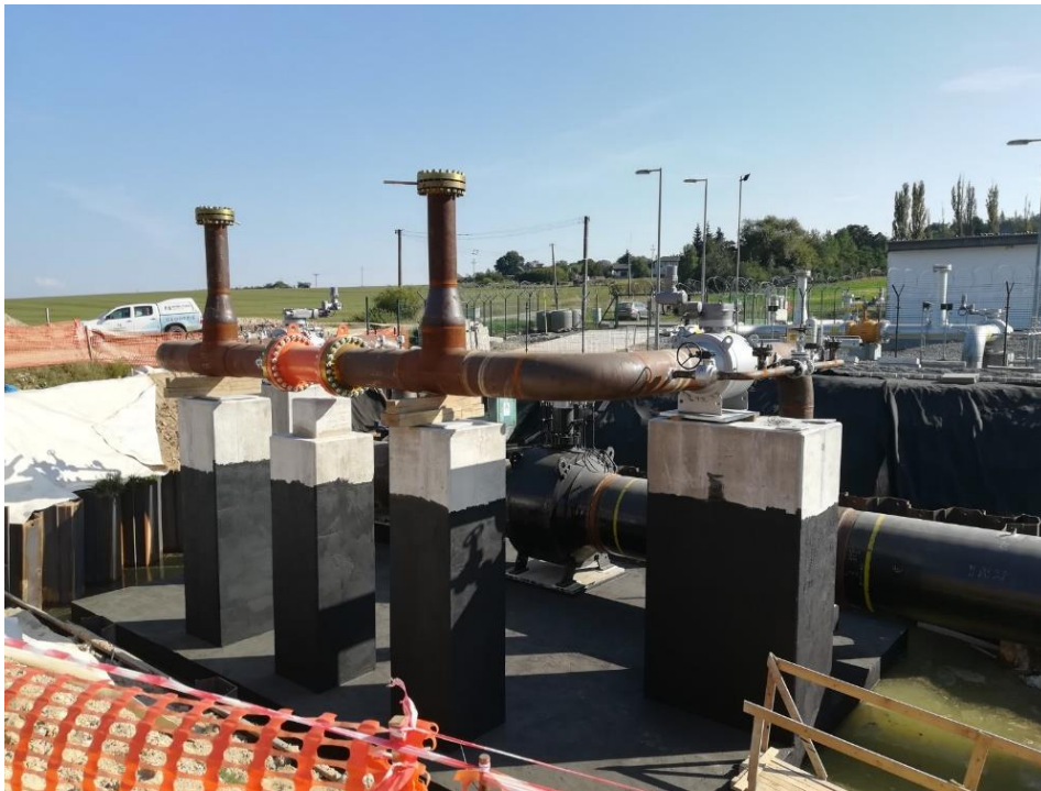
Obr. 28 Betonové pilíře s osazeným potrubím Zdroj: Autor
