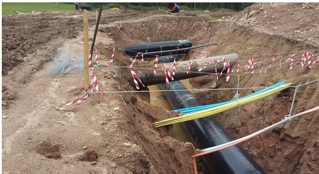
Obr. 11 Obnažené inženýrské sítě křižující plynovod Zdroj: Autor
