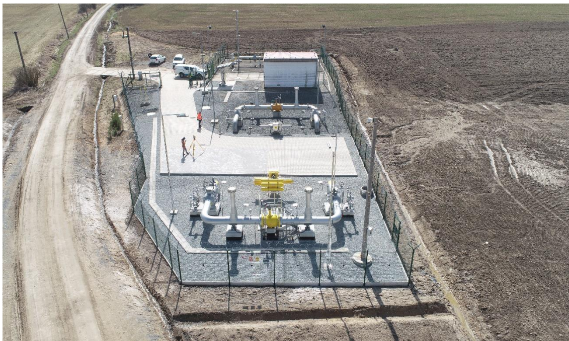
Obr. 29 Nově vybudovaná ventilová stanice Zdroj: SICIM
