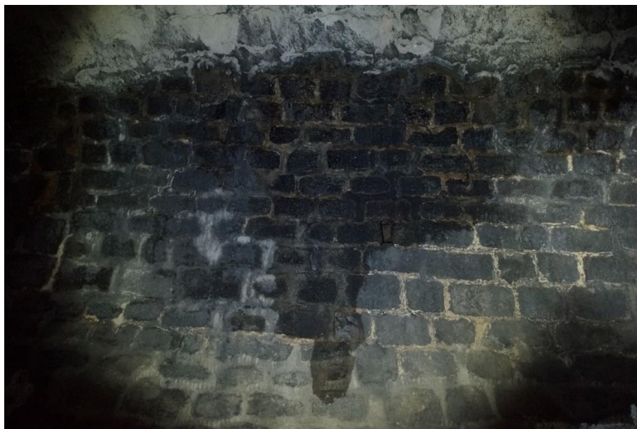
Obr. 42 – Dolnopolubenský tunel, zavlhlé místo na kamenném ostění
