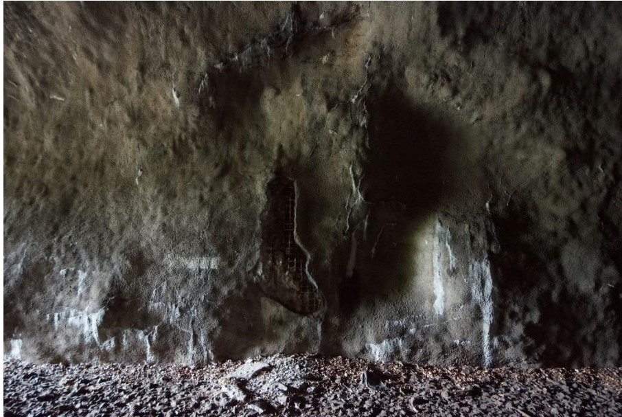
Obr. 20 – Žďárský tunel, díra v ostění
