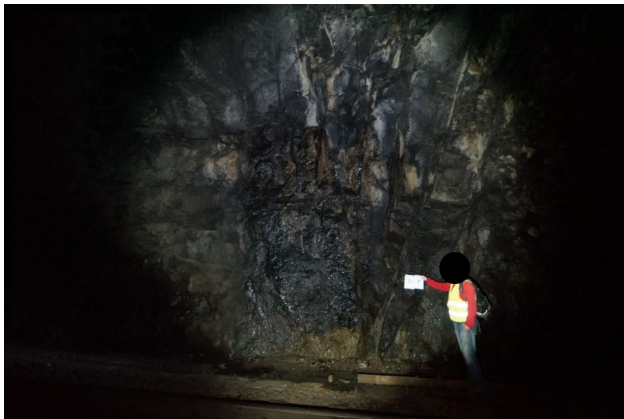
Obr. 64 – Polubenský tunel, vyvěrající voda
