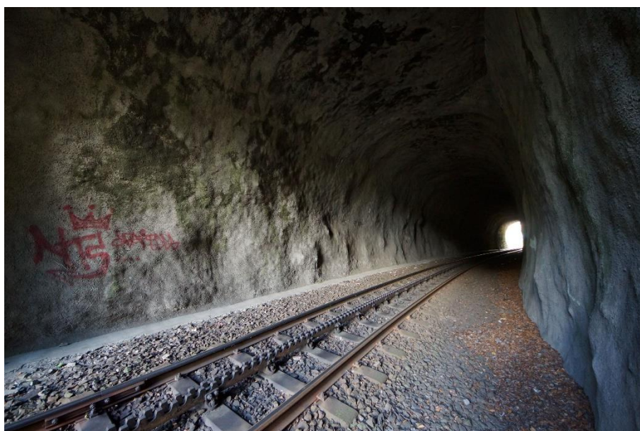
Obr. 18 – Žďárský tunel, zavlhlá místa
