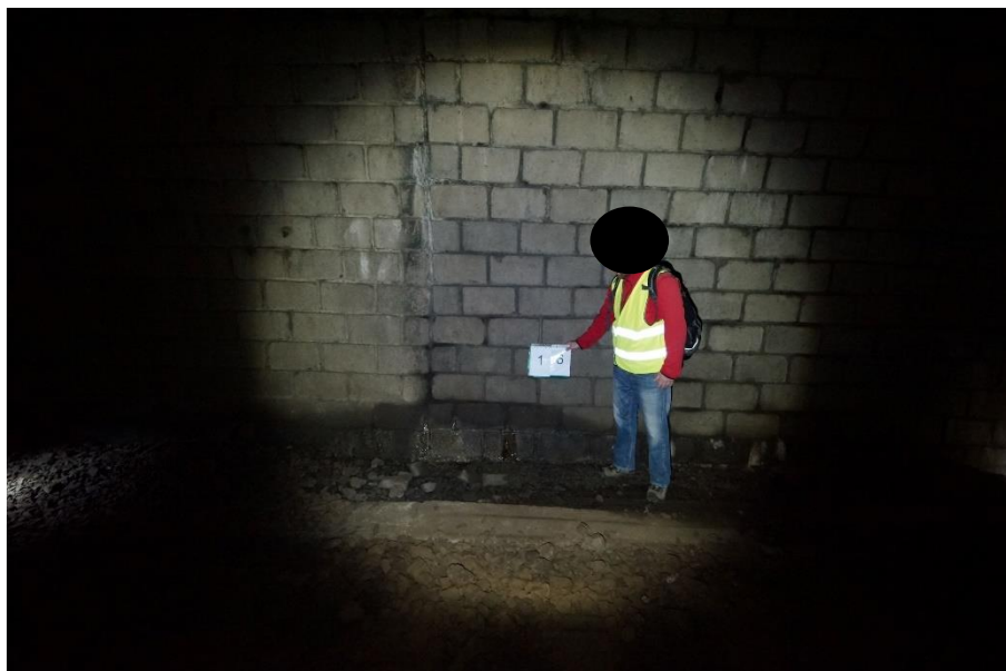
Obr. 54 – Polubenský tunel, zvlhlá pata opěry
