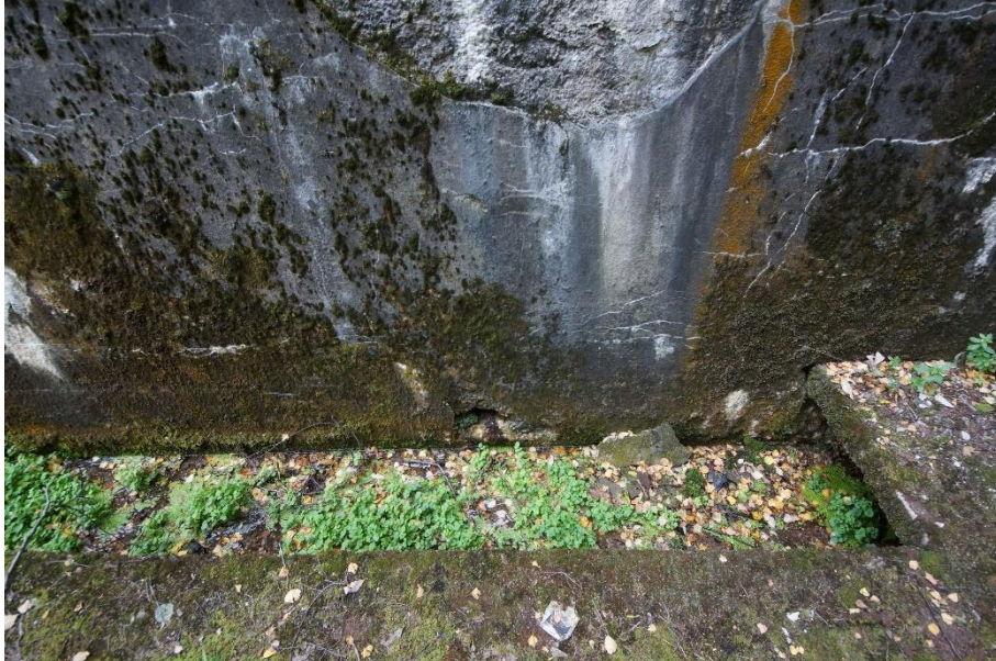
Obr. 65 – Polubenský tunel, podélné odvodnění
