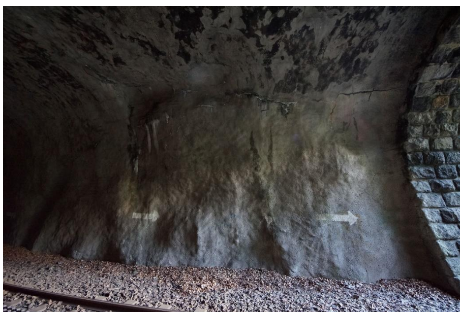
Obr. 19 – Žďárský tunel, trhliny ve stříkaném betonu
