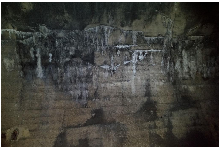
Obr. 28 – Desenský tunel, praskliny v betonovém ostění s výluhy
