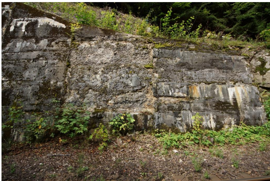
Obr. 21 – Žďárský tunel, zeď u výjezdového portálu
