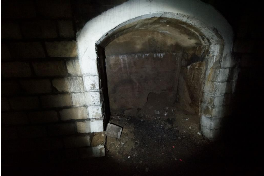
Obr. 57 – Polubenský tunel, vypadlá tvárnice
