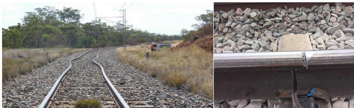
Obr. 3: Vlevo vybočená kolej [8], vpravo lom kolejnice [9]
