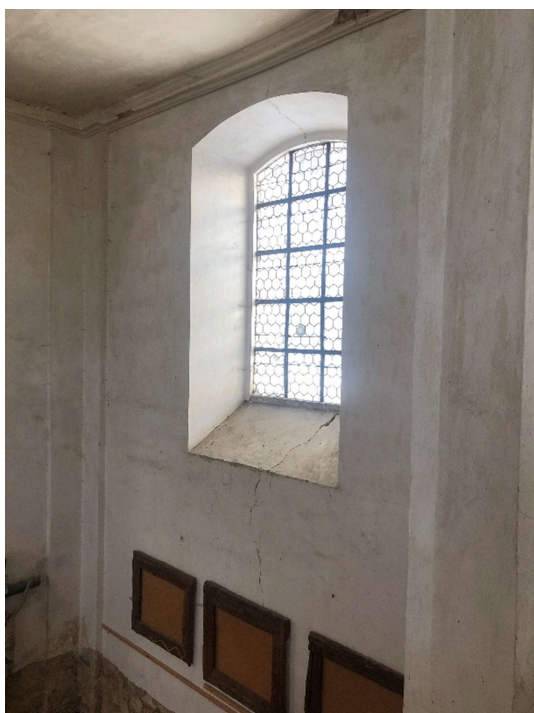
Obr. 66 – trhliny probíhající skrz okenní otvor
