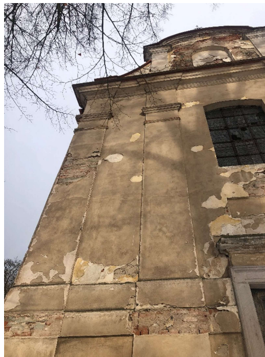
Obr. 52 – degradující omítka a obnažené zdivo
