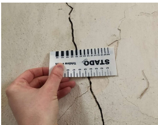
Obr. 70 – šířka trhliny na stěně hlavní lodi
