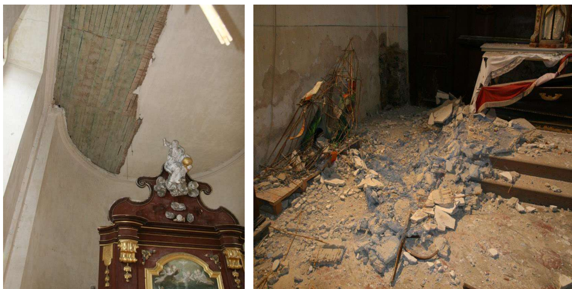
Obr. 10,11 – škody způsobené pádem stropní omítky
