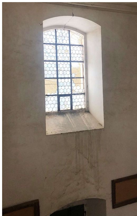
Obr. 49 – poškozené okno a vlhkostní mapy způsobené jeho zatékáním
