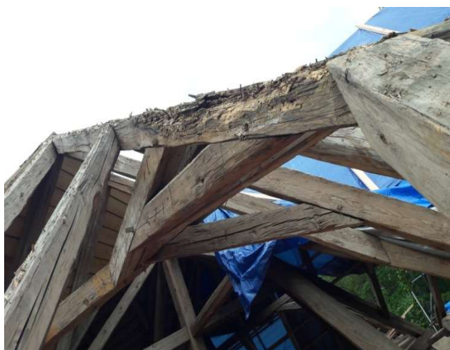
Obr. 12 – stav krovu před opravou – hniloba nárožní krokve (autor fotografie: Ing. Pavel Polák)
