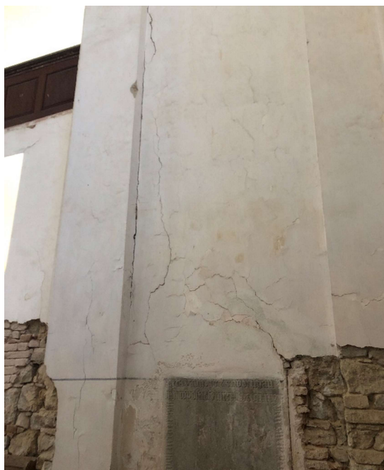
Obr. 68 – trhliny hlavní lodi v místě styku stěn a okolí náhrobního kamene
