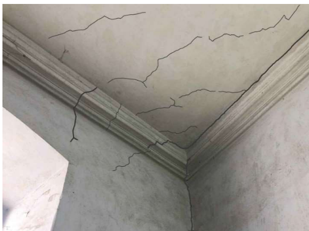
Obr. 75 – zvýrazněný průběh trhlin na stropní konstrukci jižní strany objektu
