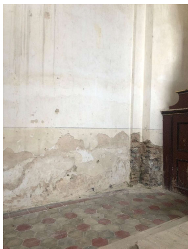
Obr. 44 – degradace omítek spodních částí stěn
