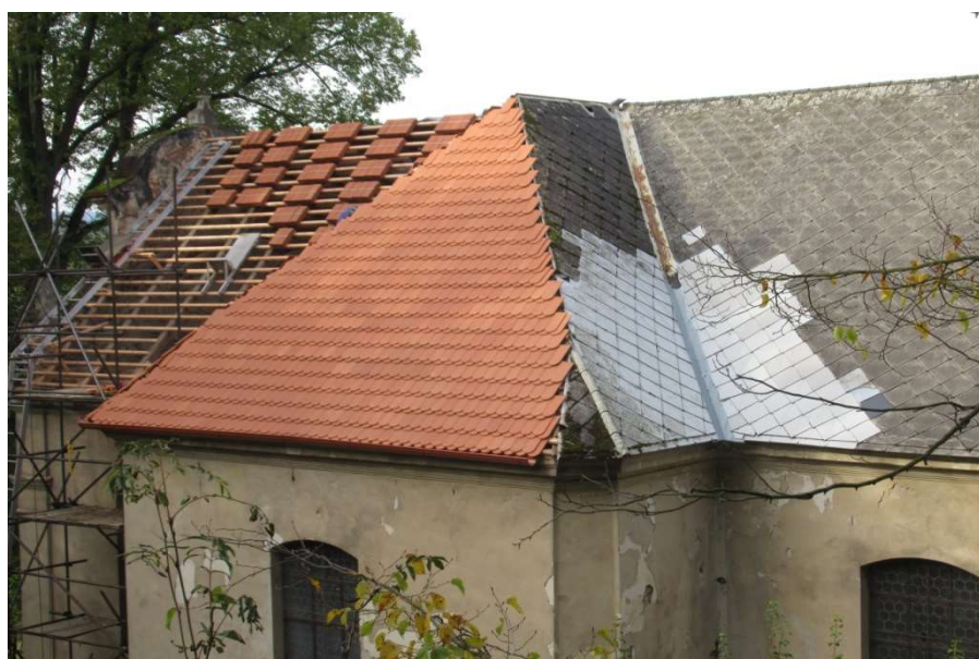
Obr. 14 – pohled na střechu v průběhu oprav a výměny krytiny původní krytina: eternitové šablony kladené na laťování/bednění nová krytina: pálené tašky (bobrovky) kladené na laťování (autor fotografie: Biskupství plzeňské)
