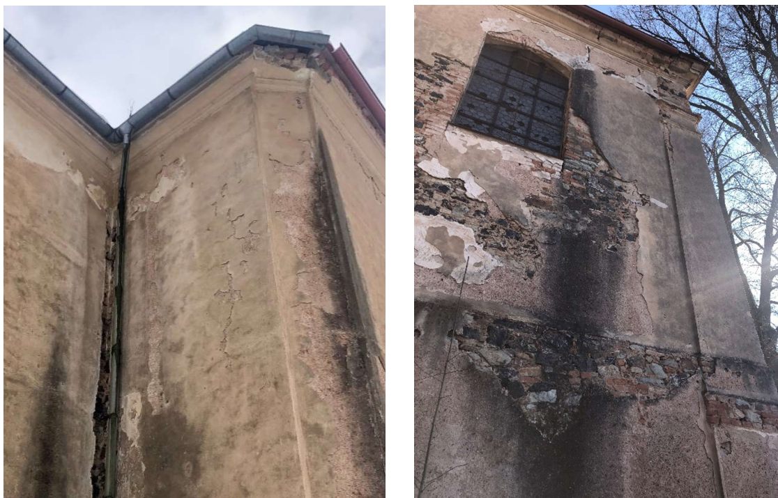
Obr. 50, 51 - opadané římsy, plíseň a degradace omítky vlivem zatékání a nefungujících prvků pro odvod srážkové vody
