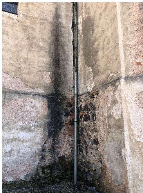
Obr. 65 – projev plísně v místě svodu
