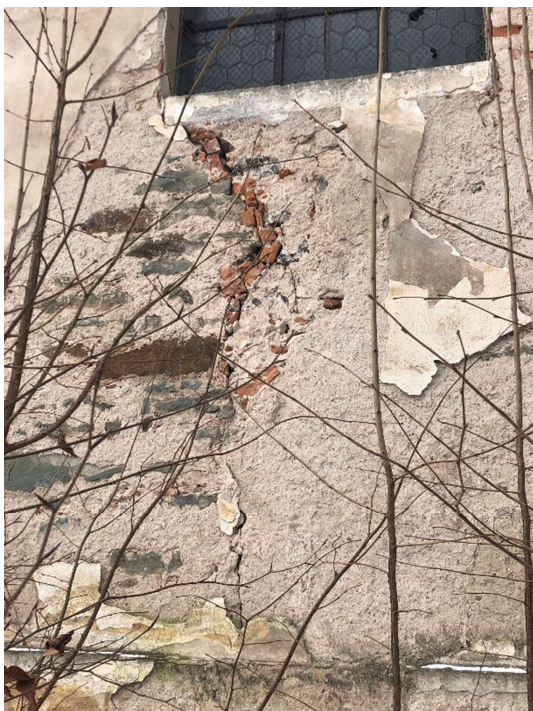
Obr. 72 – trhlina pod okenním otvorem na východní fasádě
