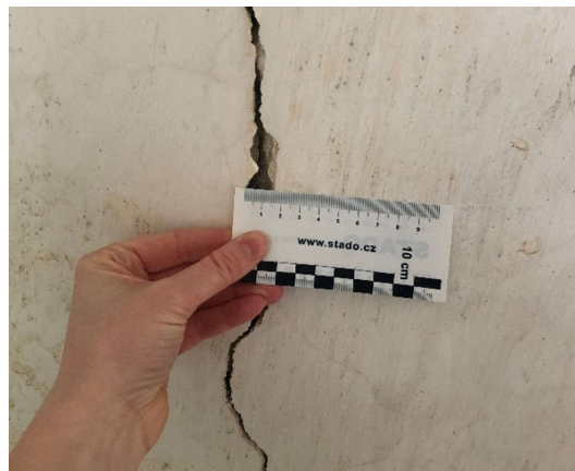
Obr. 71 – šířka trhliny na stěně krucht
