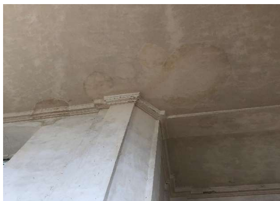
Obr. 47 – skvrny způsobené zatékáním střešní konstrukce
