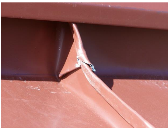
Obrázek 25 - Příklad špatně provedeného spoje [30]
