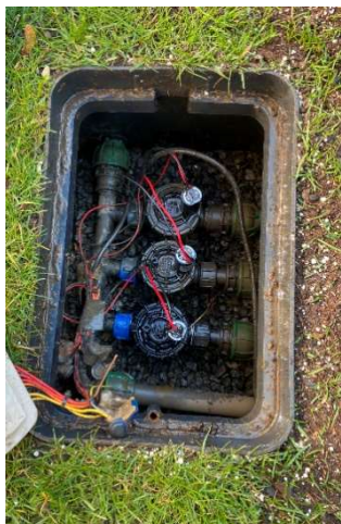
Obr. 3: Šachtice s elektroventily
