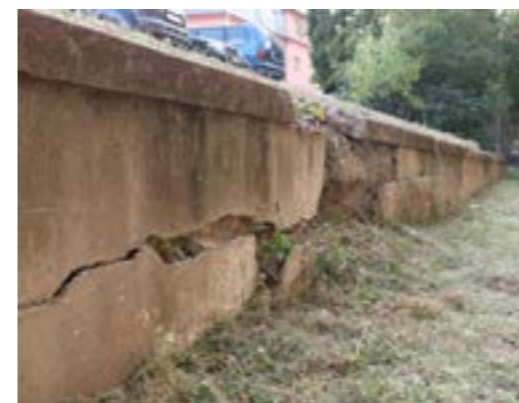
zídka vyžadující opravu
