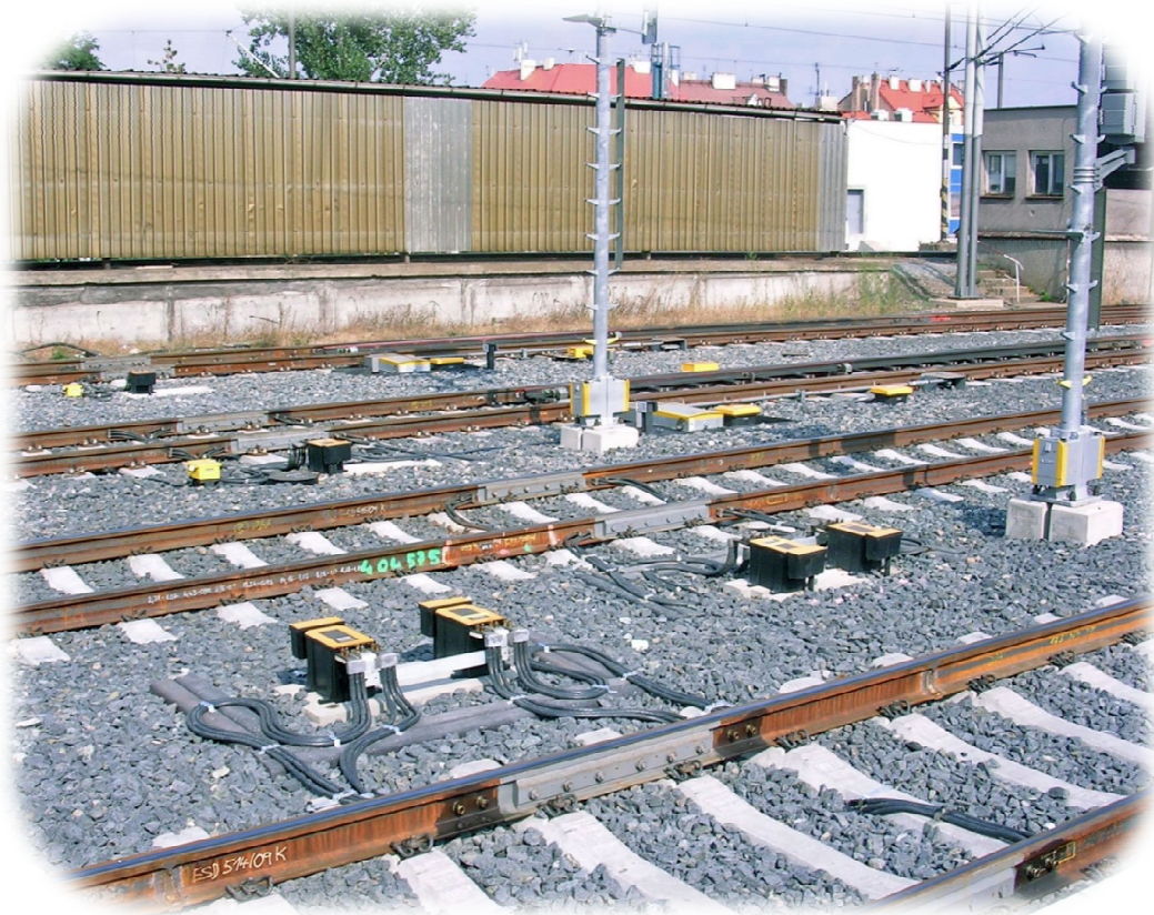
Obr.2 – Izolované styky se stykovými transformátory ve stanici Praha-Libeň
