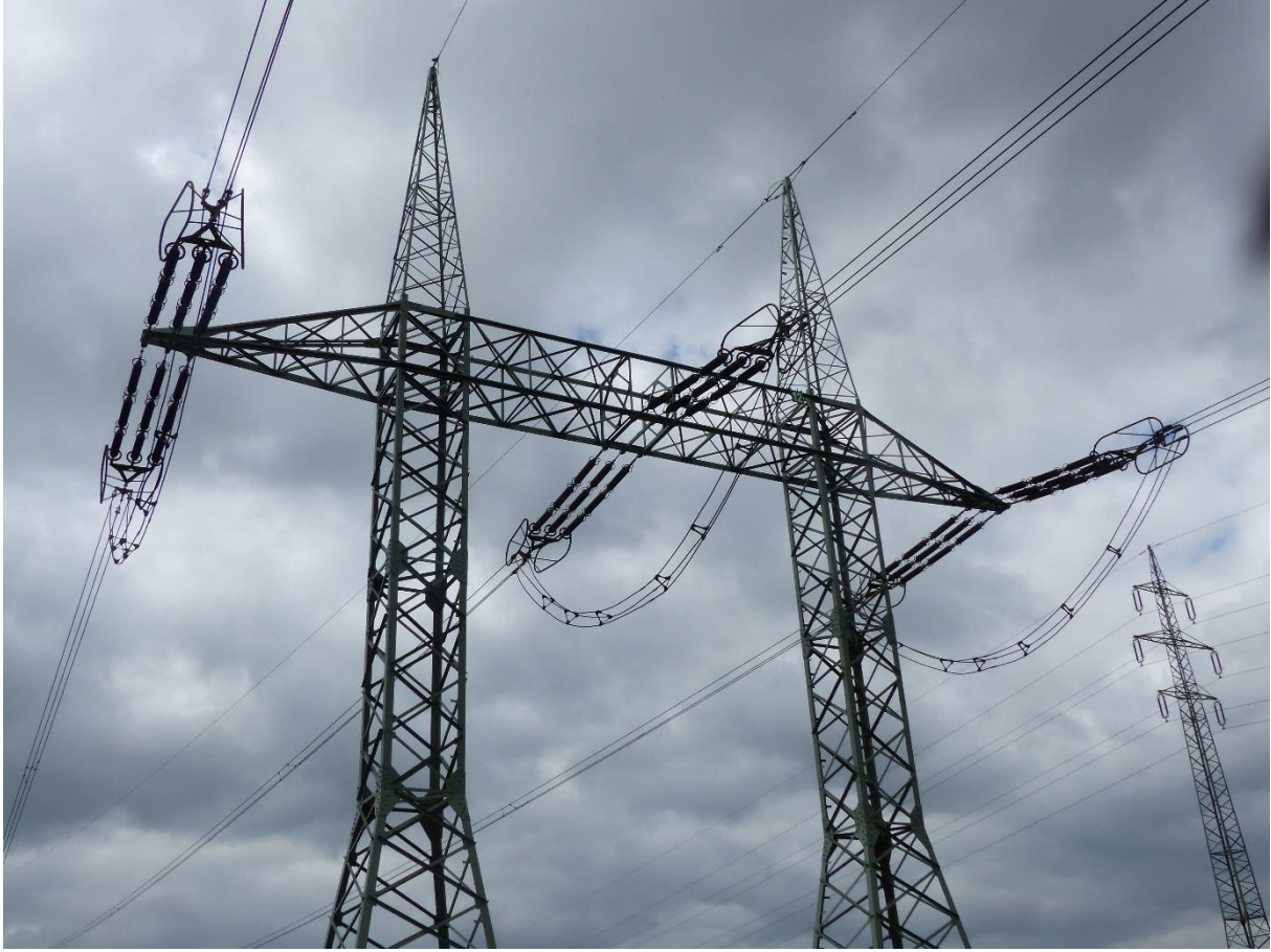
Obrázek 39: Kotevní stožár typu Portál s trojitými kotevními izolátorovými závěsy s trojbodovým uchycením
