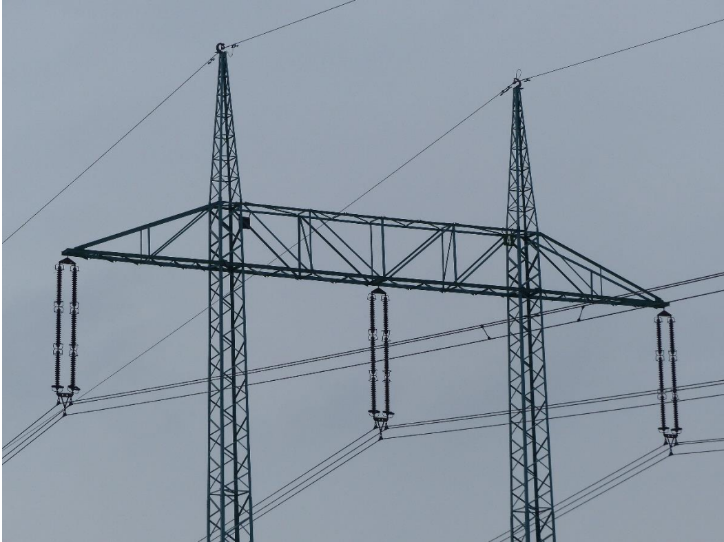
Obrázek 36: Nosný stožár typu Portál s dvojitými nosnými izolátorovými závěsy s jednobodovým uchycením
