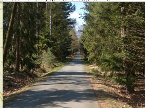
Závada Z23 - strmý sjezd (sklon 8%), 2,6. - 2,9. km
