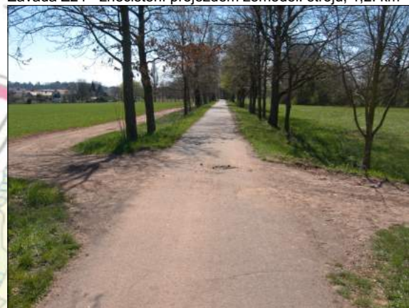
Závada Z24 - znečištění přejezdem zeměděl. strojů, 1,2. km
