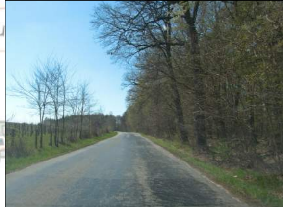
Závada Z21 - absence nezpevněné krajnice, 4,2. - 6,5. km
