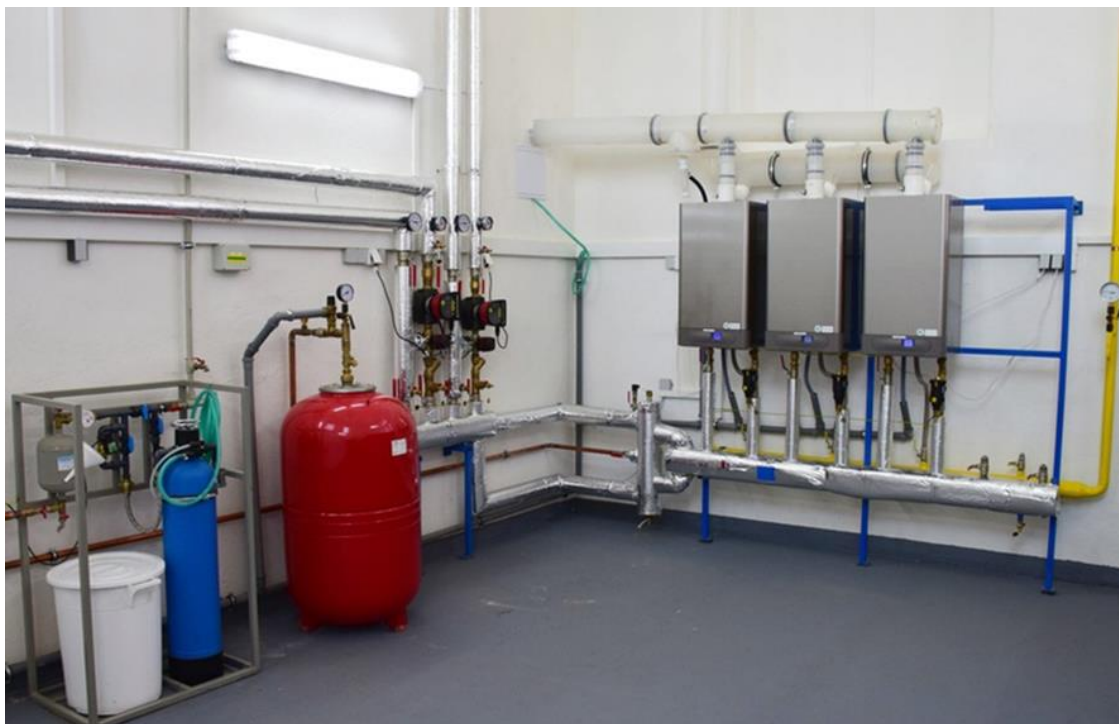
Obr. 3.3 Plynová kotelna s kaskádou tří plynových kondenzačních kotlů 52
