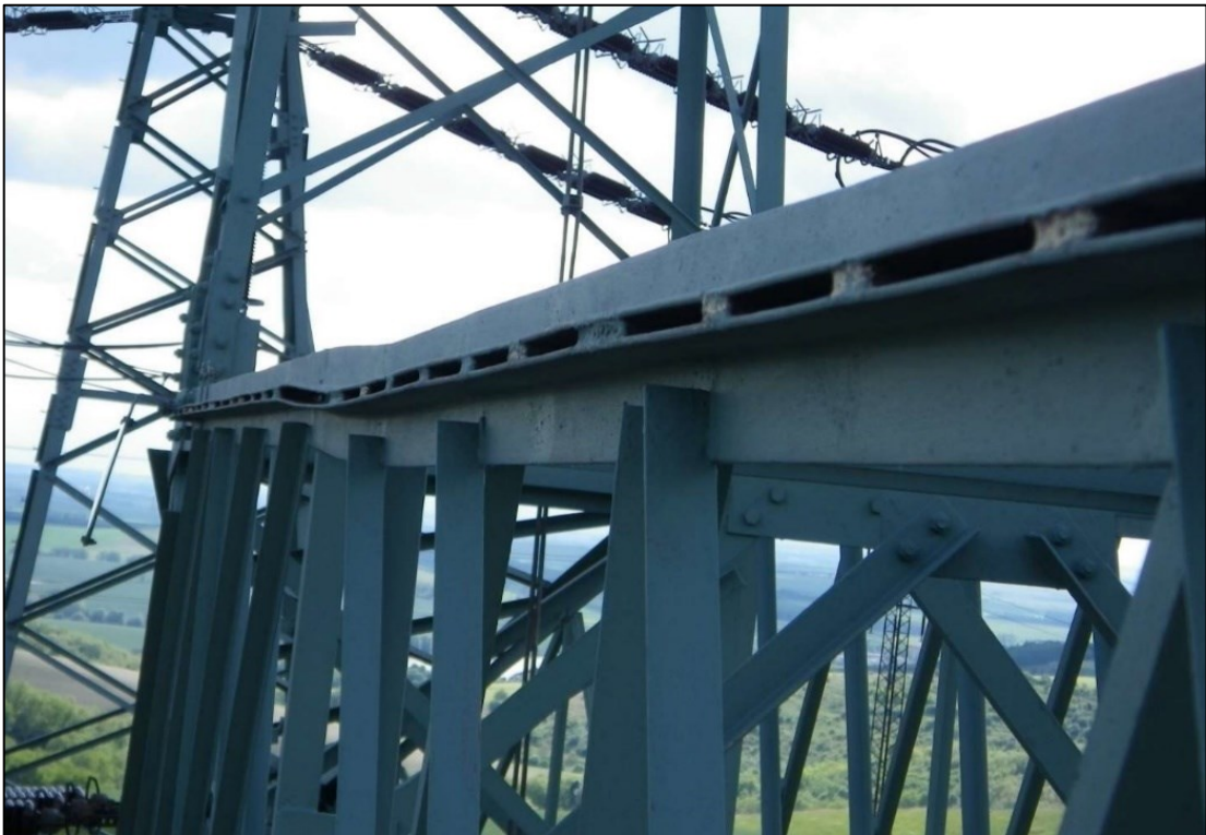
Obrázek 7: Deformace mostu stožáru typu Portál 22
