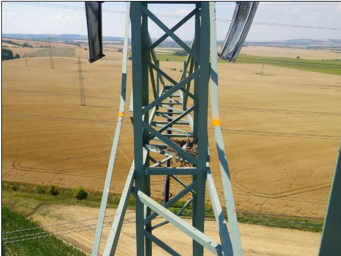
Obrázek 8: Deformace výztužných závěsů konzole 23
