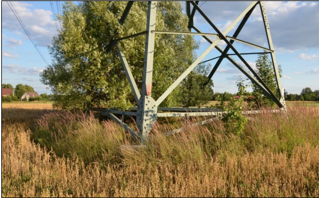
Obrázek 5: Zarostlý základ stožárové konstrukce 20
