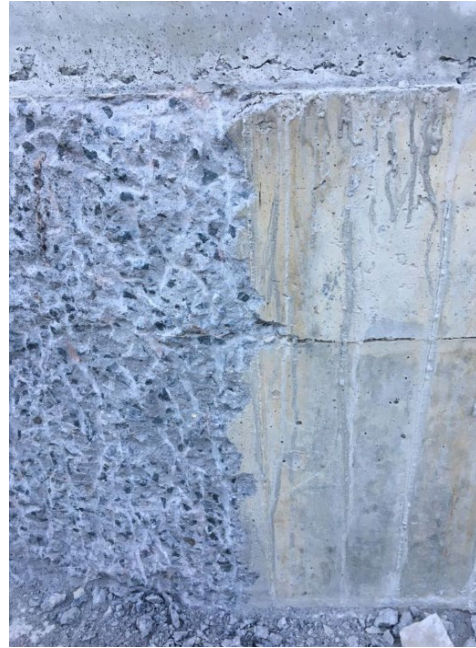
Obr. 22 – správně zhutněný beton, vlevo otlučená část pomocí hydraulického kladiva – rovnoměrné rozložení kameniva
