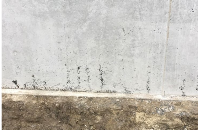
Obr. 21 – kaverny na styku základové konstrukce a obvodové stěny z exteriéru
