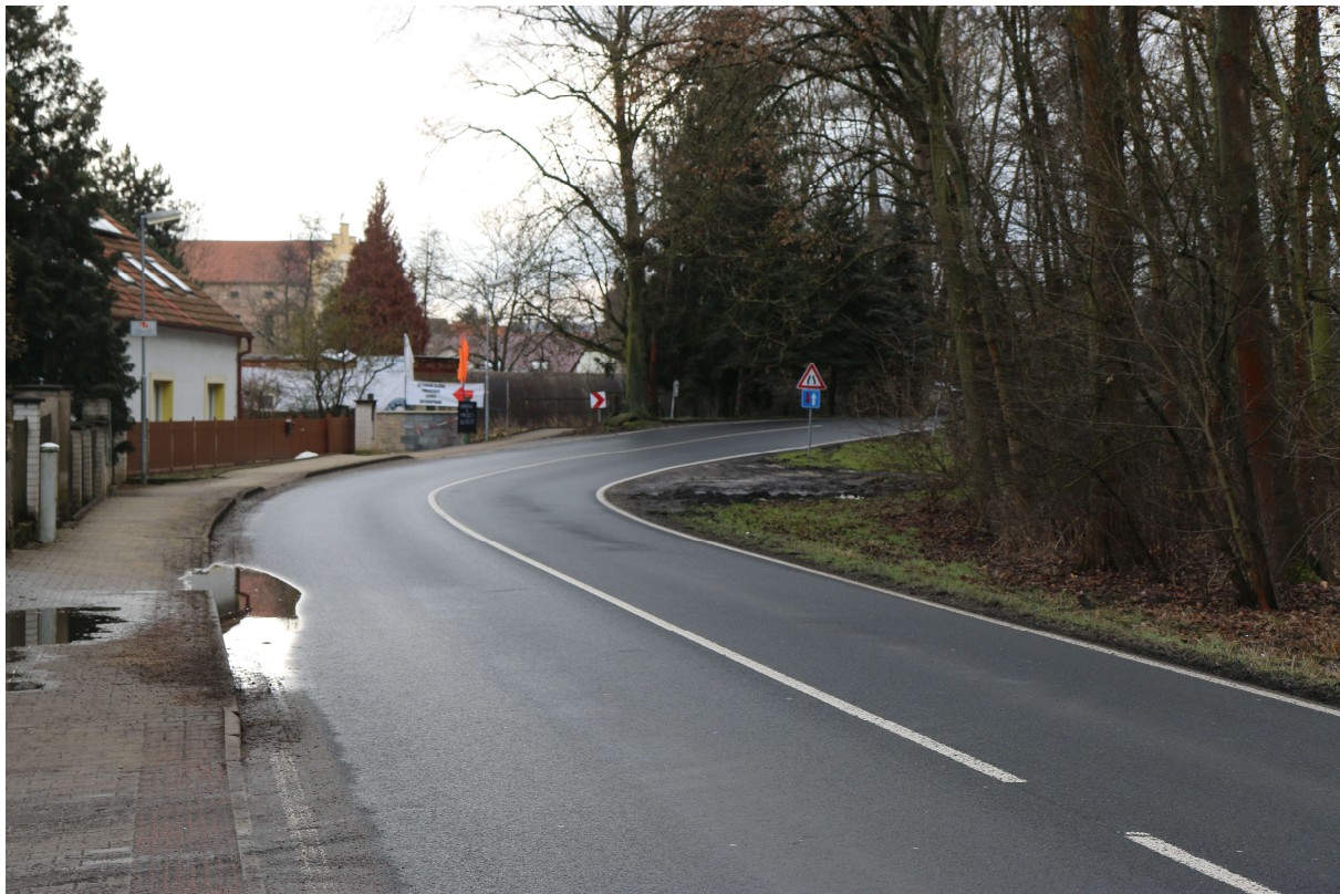
Foto č. 2 – Nedostatečný poloměr směrového oblouku
