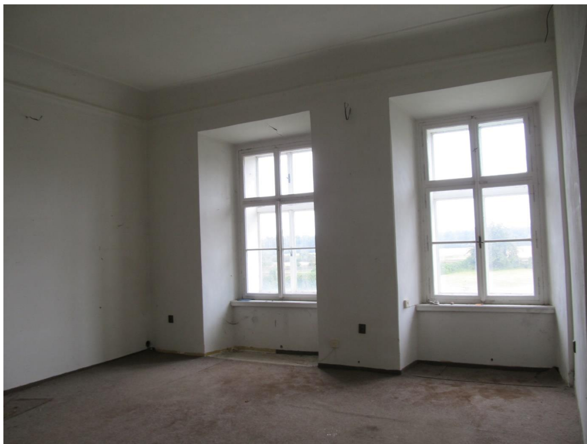
Foto 30 Bývalá třída 2.10; pravé okno probourané dodatečně, levé okno původní otvor, vpravo přepaženo novodobou příčkou
