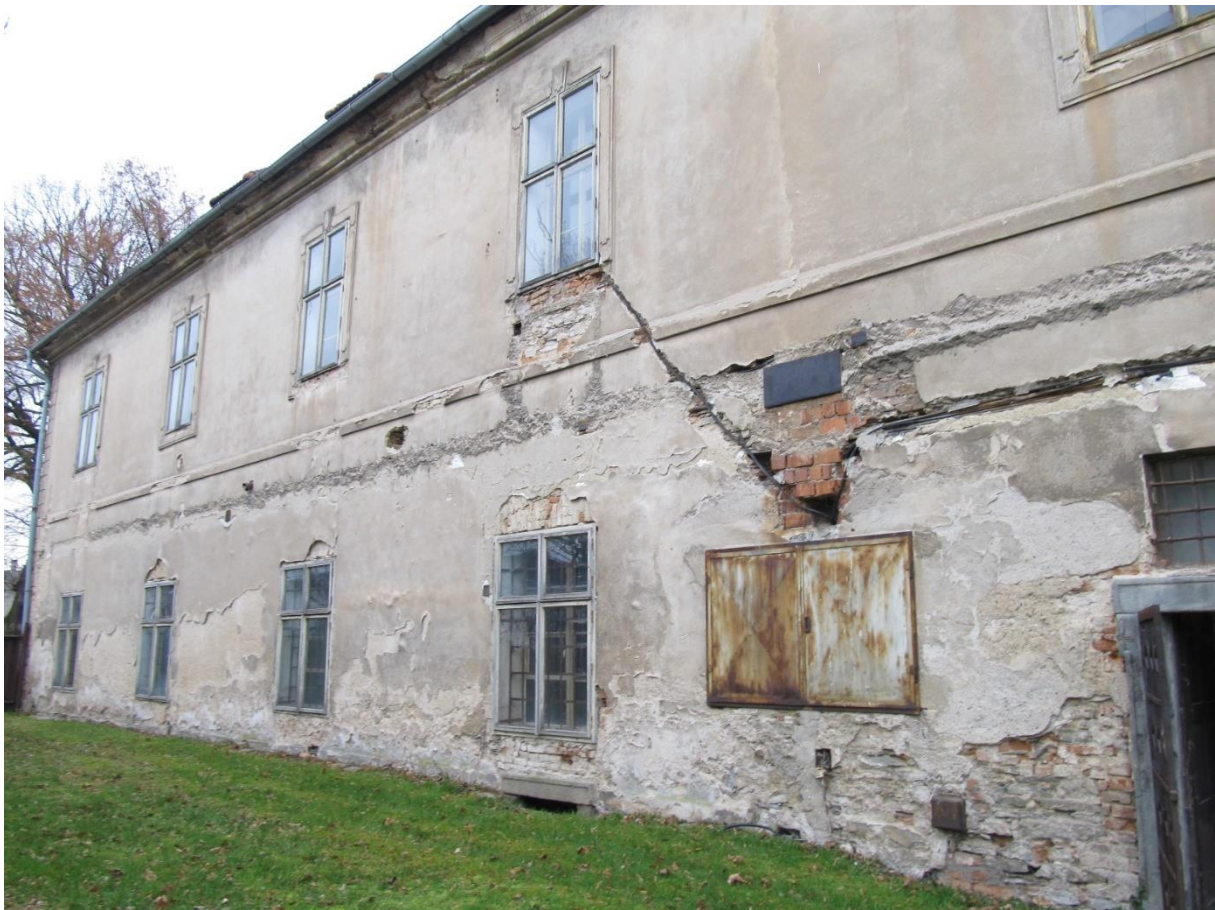
Foto 18 JV fasáda - pouze první sklepní okénko zvenku viditelné, ostatní pod pokryvem zeminy, vpravo kamenný portál vchodu na zahradu, okna v přízemí vedou (počítáno od vchodu na zahradu) 2 do kuchyně, 2 do refektáře, horní okna asi do ložnic, přízemní okna dnes postrádají šambránu – z neznámých důvodů
