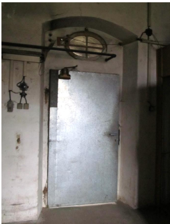
Foto 13 Tytéž dveře, ze strany místnosti, dodatečně opatřené oplechováním
