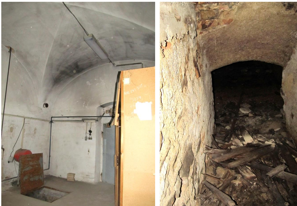
Foto 14 Pohled na místnost s průchodem ke studni směrem k vstupním dveřím, dveře oplechovány, vlevo dole poklop uzavírající vchod do sklepa;
