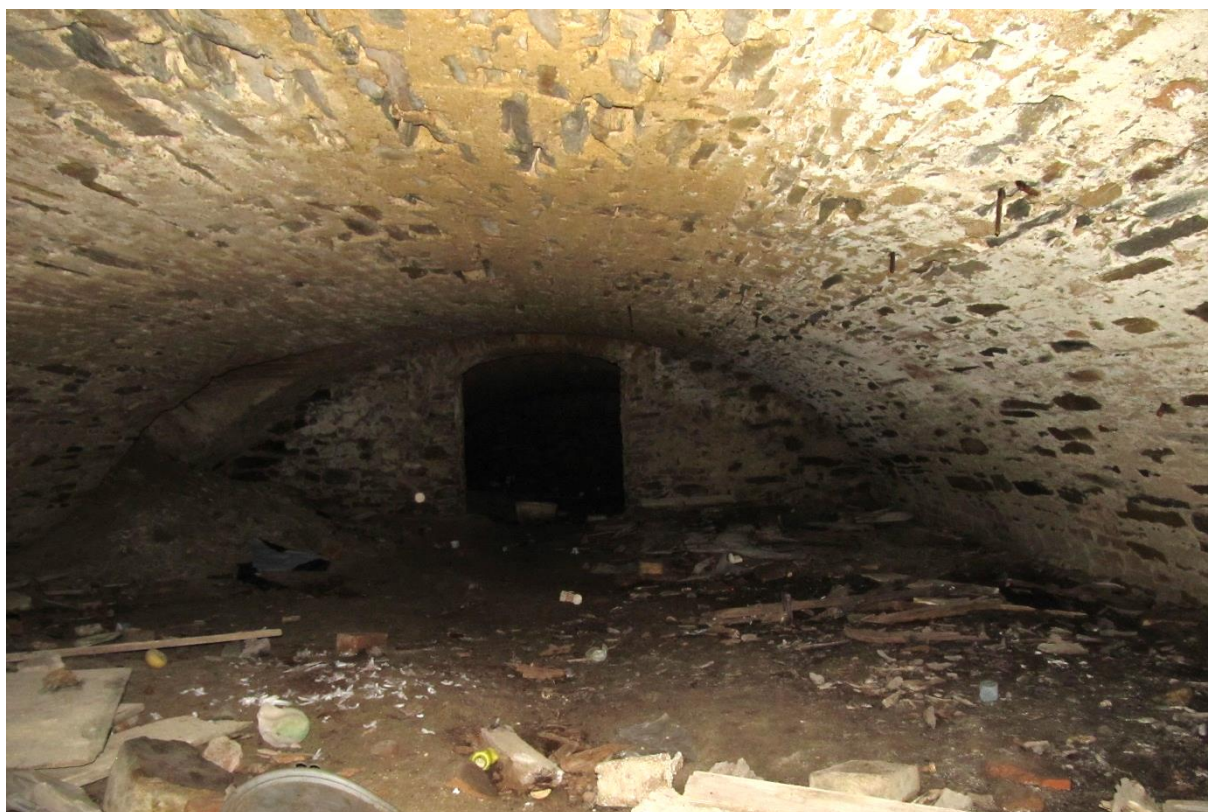
Foto 17 První velká místnost sklepa (pod kuchyní) - u okénka (vlevo) znatelný nával zeminy, uprostřed dělicí stěny klenutý průchod, sklep má klasickou valenou klenbu s výsečemi s okny, klenba z plošších podlouhlých kamenů, neomítnuté
