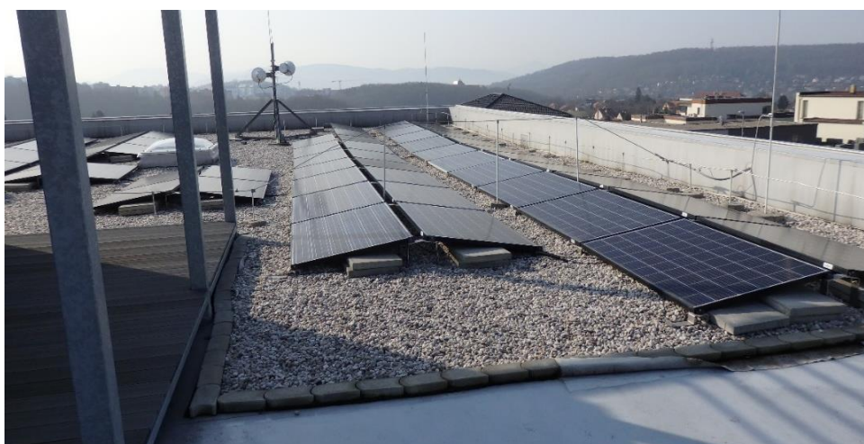
Obrázek 5.6 Část fotovoltaické elektrárny na střeše objektu
