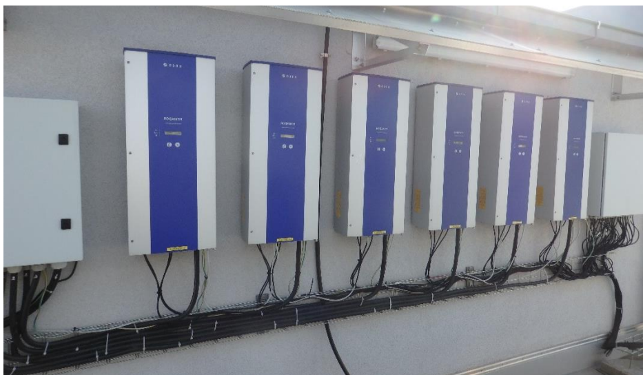
Obrázek 5.7 Střídače a rozvody pro FVE
