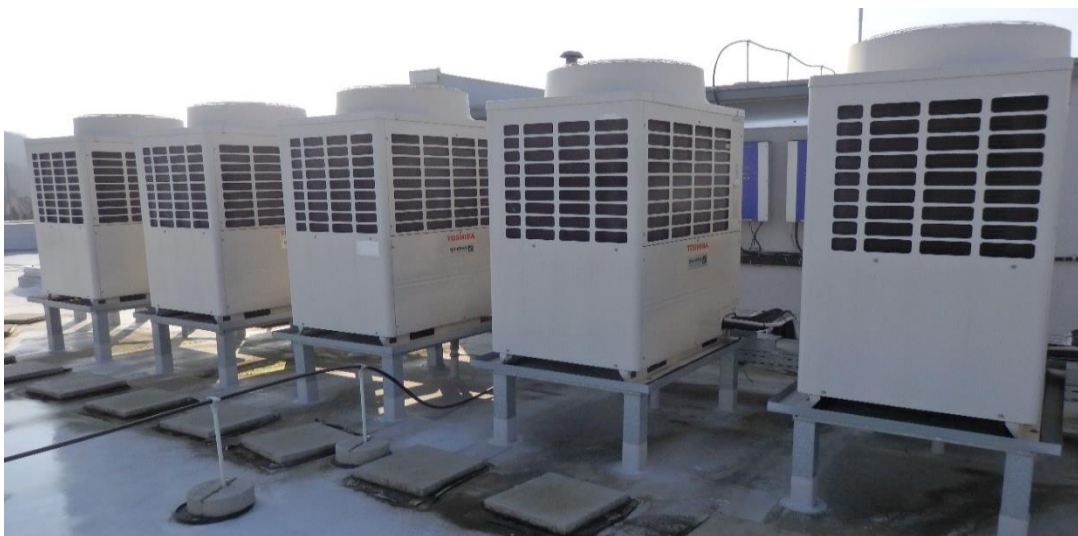
Obrázek 5.4 Tepelná čerpadla umístěná na střeše objektu
