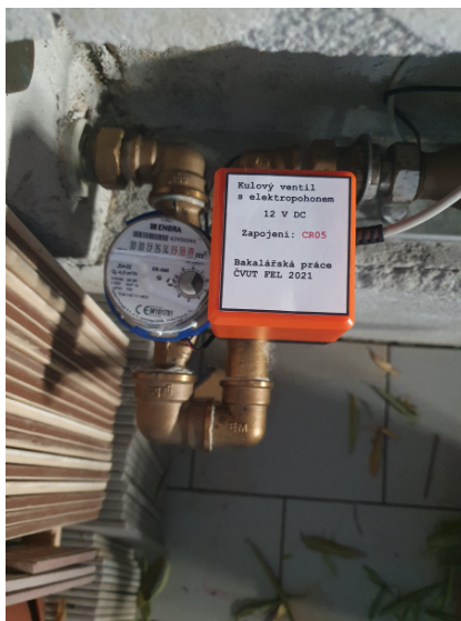
Obrázek č. 20: Nainstalovaný impulsní vodoměr spolu s kulovým ventilem na hlavním přívodu vody
