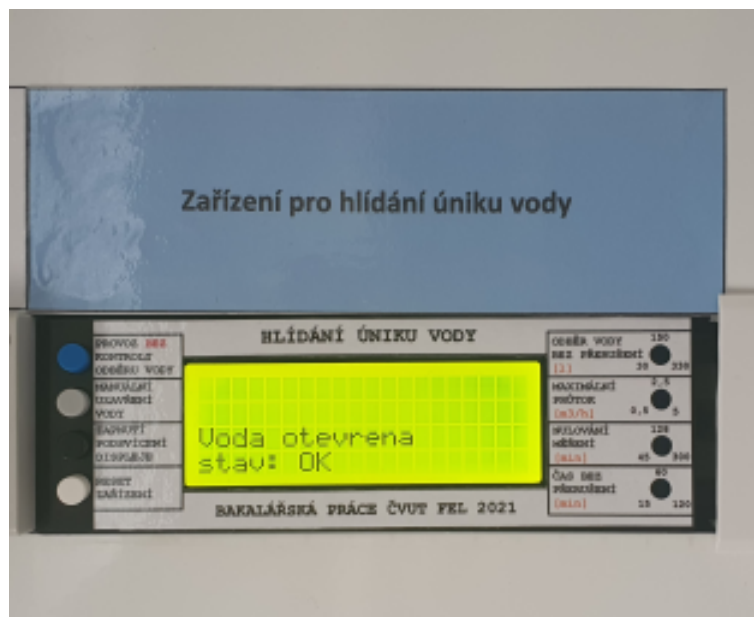
Obrázek č. 31: Zapojení zařízení v rozvaděči v provozu se zapnutým podsvícením displeje
