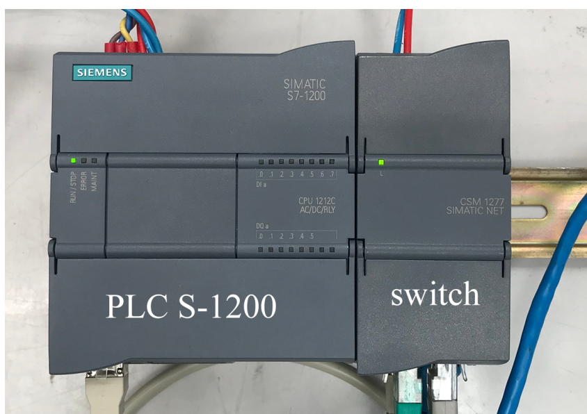
Obr. 4 - 4 Detail použitého PLC Simatics S-1200 s CPU 1212C AC/DC/RLY a modulu switch
