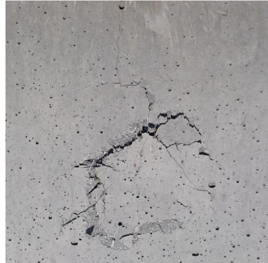
Obr. 90 Porušení bez scabbingu na zadní straně UHPFRC desky ze svisle orientovaného bednění.
