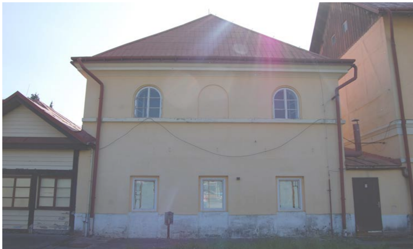
Severní fasáda kuchyně s nevhodnými okenními otvory v přízemí
