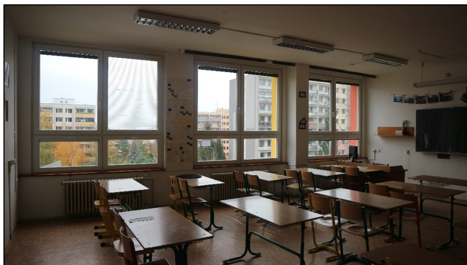
Obr. 14 - ZŠ Jana Palacha v Kutné Hoře, učebna IX.A, pohled na okenní výplně
