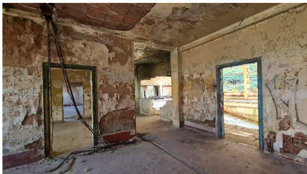
Obr. 3.34 Pozůstatek interiérových zárubní
