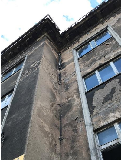
Obr. 3.70 Degradace povrchových vrstev vlivem vlhkosti
