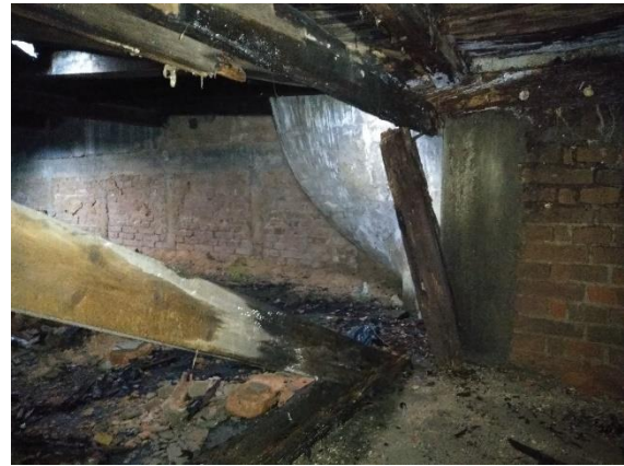
Obr. 3.60 Havarijní stav dřevěných prvků
