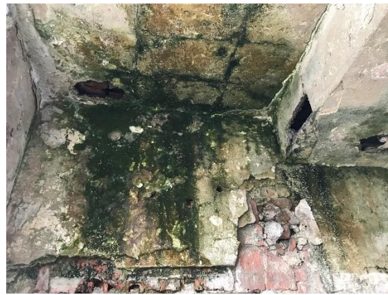
Obr. 3.69 Degradace vnitřních omítek
