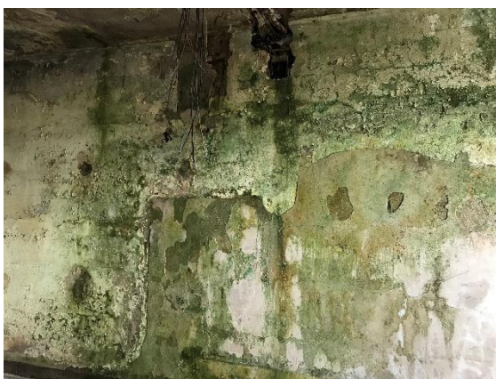
Obr. 3.68 Degradace vnitřních omítek
