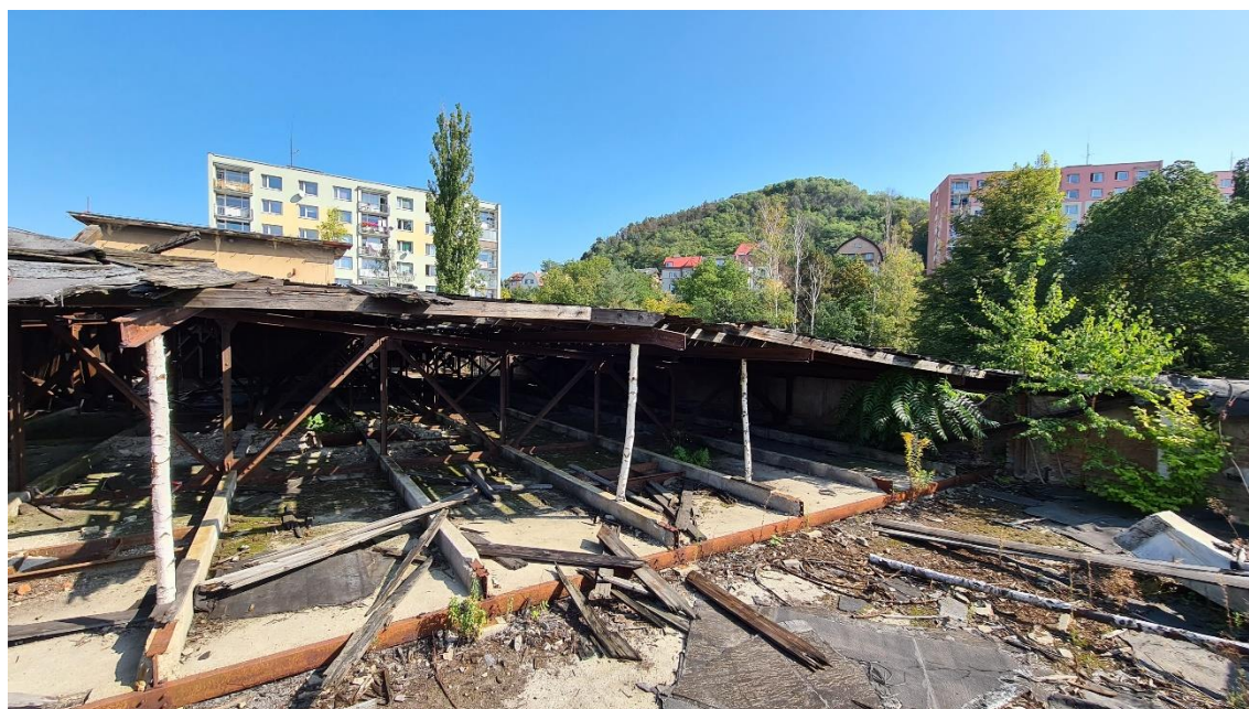
Obr. 3.54 Pohled na konstrukci s chybějící krajní vazbou
