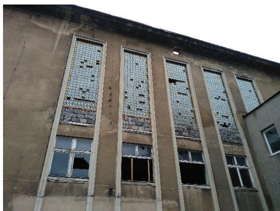
Obr. 3.65 Stav okenních výplní (JZ)
