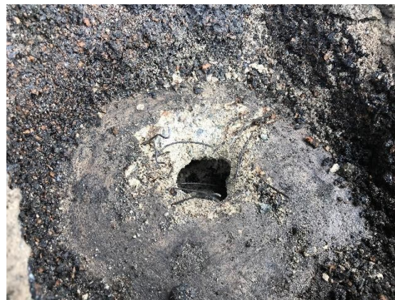
Obr. 3.89 Pohled na prefabrikovanou betonovou desku s vytvořeným otvorem a obnaženou výztuží
