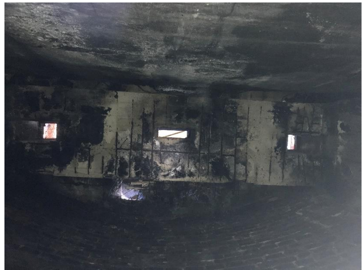
Obr. 3.45 Stav trámu mezi suterénem a halou
