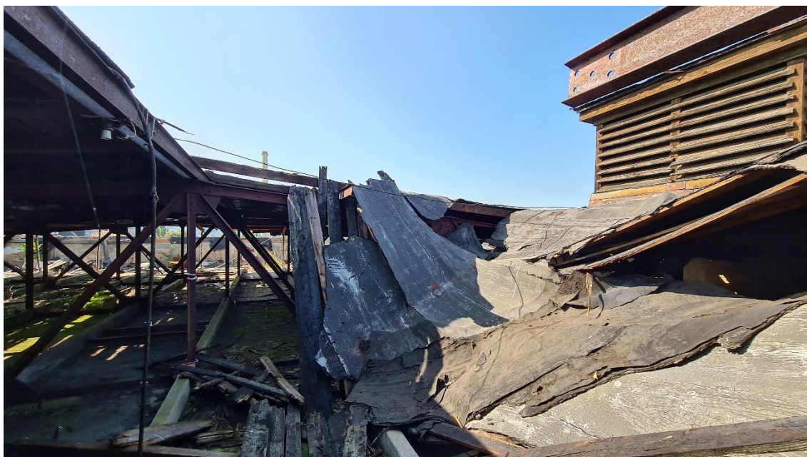
Obr. 3.53 Stav střešního pláště
