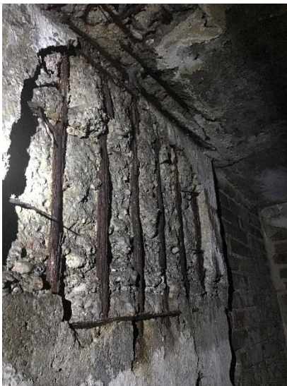
Obr. 3.44 Degradace suterénního pilíře
