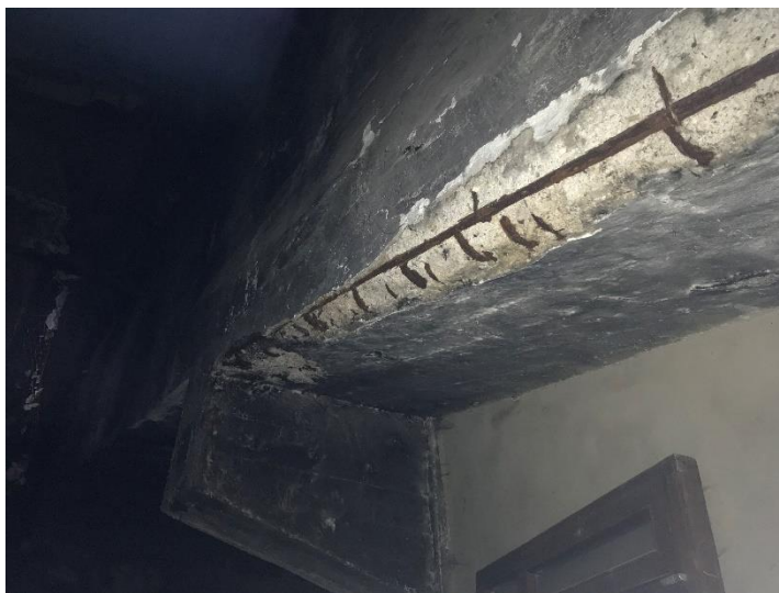
Obr. 3.72 Lokální poruchy nosné konstrukce bazénu
