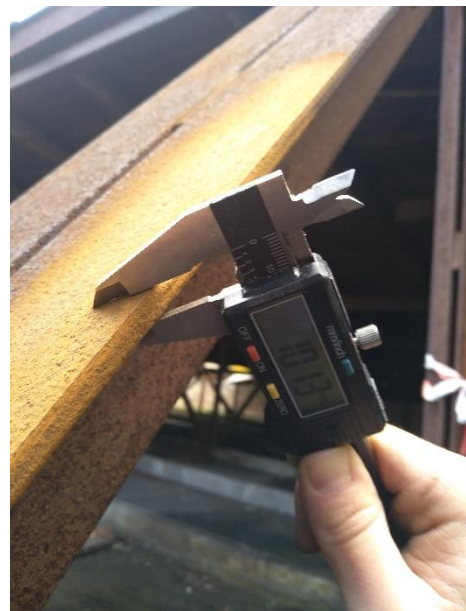
Obr. 3.93 Měření úbytku tloušťky prvků
