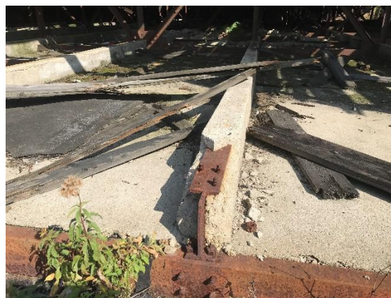
Obr. 3.56 Detail krajní vazby po odcizení
