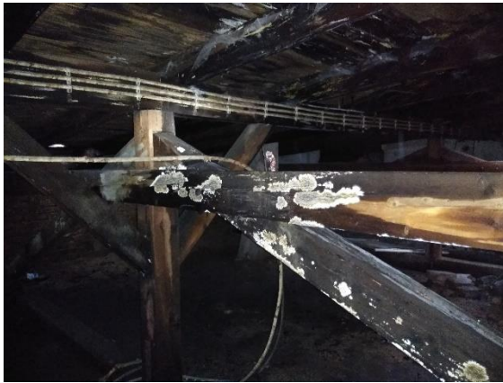
Obr. 3.61 Degradace dřevěných prvků
