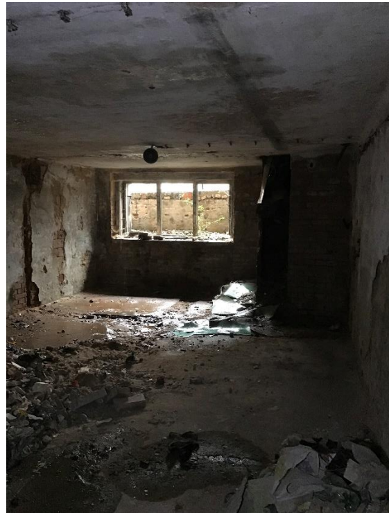
Obr. 3.43 Místnost suterénu postižená vysokou vlhkostí
