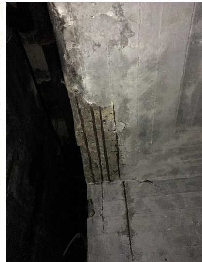
Obr. 3.73 Lokální poruchy nosné konstrukce bazénu
