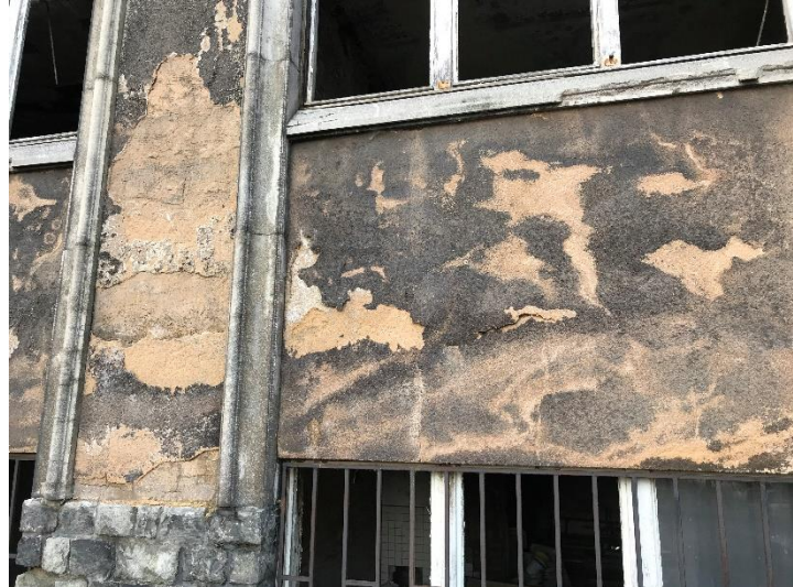
Obr. 3.71 Pohled na poškozenou fasádu vlivem vlhkosti
