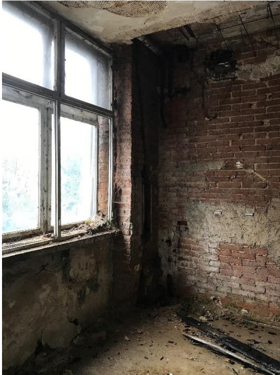
Obr. 3.42 Obvodové stěny postižené vysokou vlhkostí
