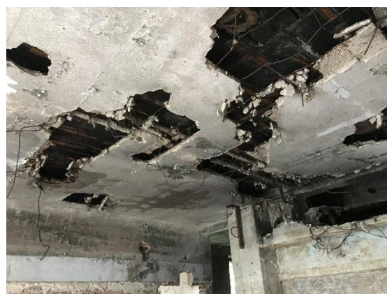
Obr. 3.51 Stav podhledů (1.NP)
