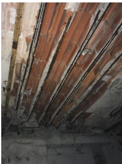
Obr. 3.47 Poškození stropní konstrukce (suterén)
