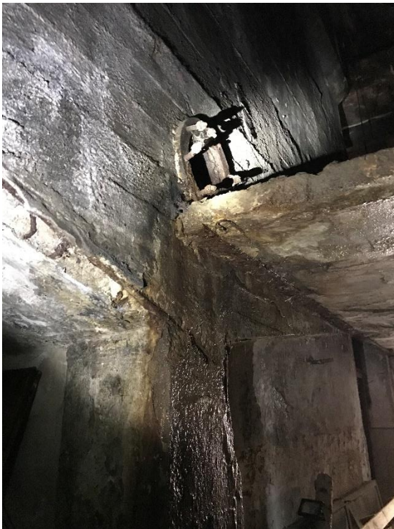
Obr. 3.74 Výtokové potrubí bazénu
