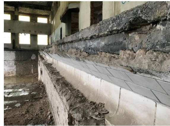
Obr. 3.40 Detail stavu hrany bazénové vany
