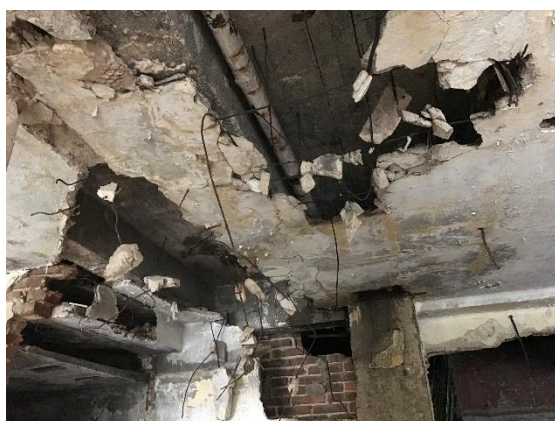
Obr. 3.52 Stav podhledů (1.PP)
