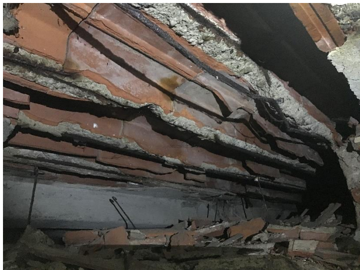
Obr. 3.48 Poškození stropní konstrukce (suterén)
