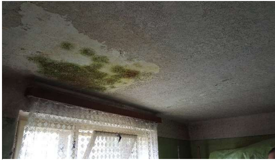
Obrázek 23: Vlhkostní mapy na stropu – jižní pokoj, (zdroj: autor)
