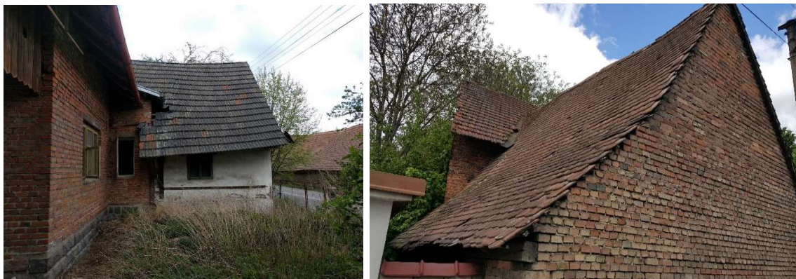
Obrázek 20: Deformace střešní roviny – původní část stavení, (zdroj: autor)
