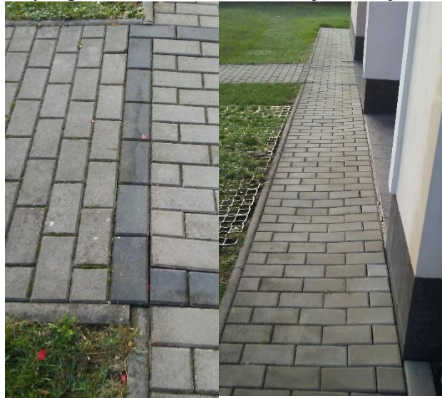
Obrázek 27 - Napojení dlažby [16], Obrázek 26 - Propadlá dlažba [16]
