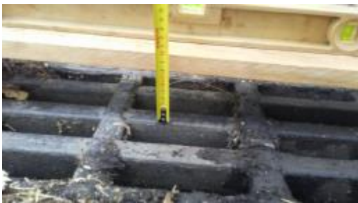
Obrázek 43 - Propadlý poklop kanalizace [23]
