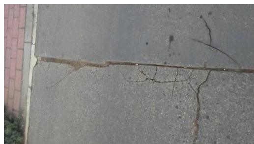
Obrázek 42 - Trhlina ve vozovce [23]
