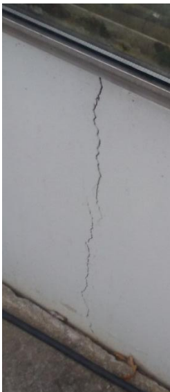
Obrázek 32 - Trhlina ve zdivu [17]
