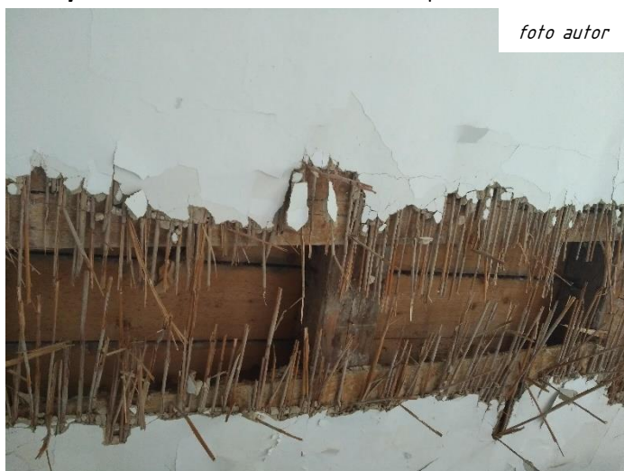
Obrázek 28 – Současný stav dřevěných trámů
