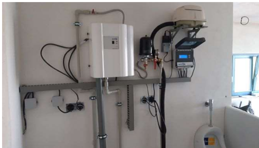
Obrázek 25: Umístění řídicí jednotky v technické místnosti. [25]
