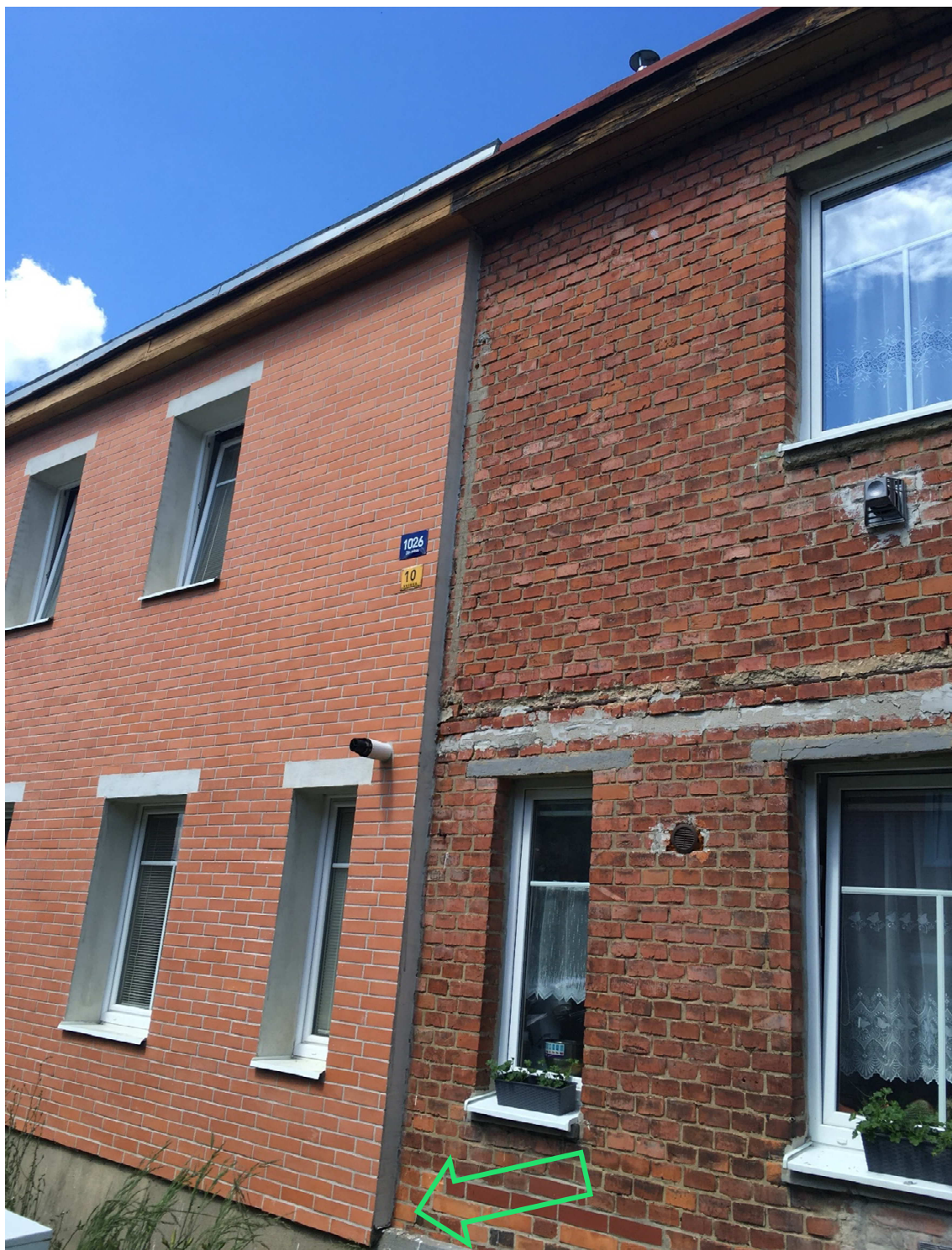
Obrázek 51 - foto částečně zatepleného Baťovského domku ve Zlíně z osobní prohlídky dne 23.6.2020
