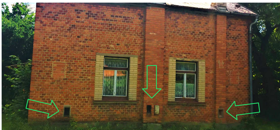
Obrázek 31 – foto severní fasády budovy z osobní prohlídky dne 23.6.2020 s vyznačením revizních dvířek
