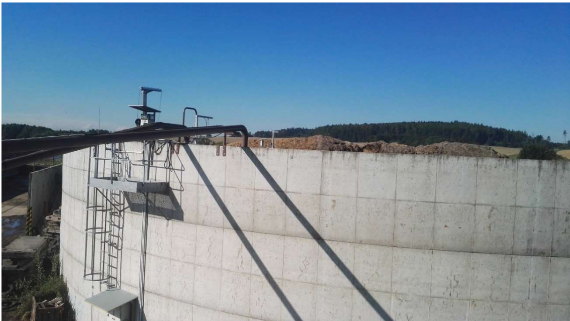
Obrázek 9: Pohled na skladovací jímku
