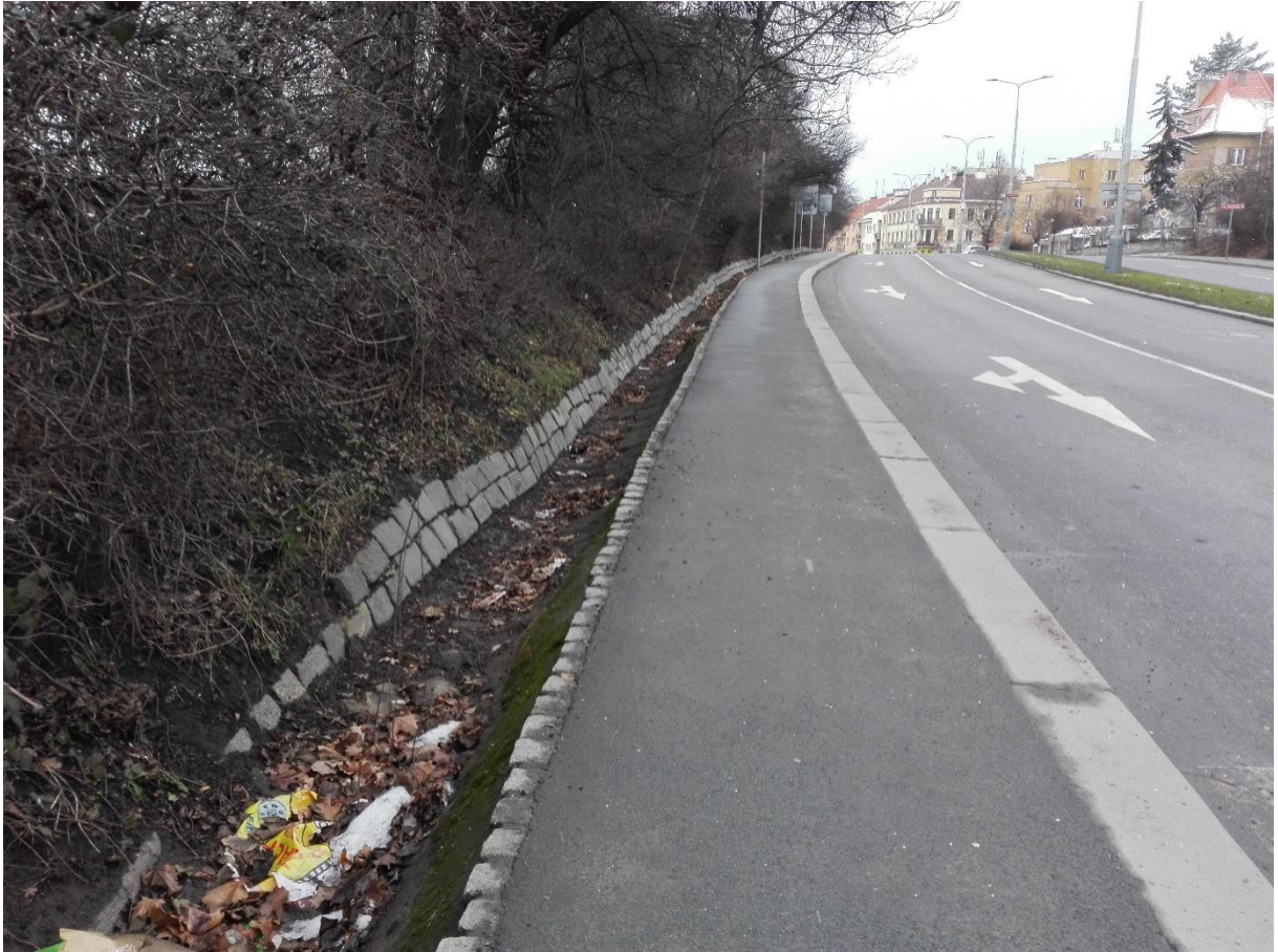
1-16 Neudržovaný příkop v úseku Pod Šancemi – Na Balkáně.
