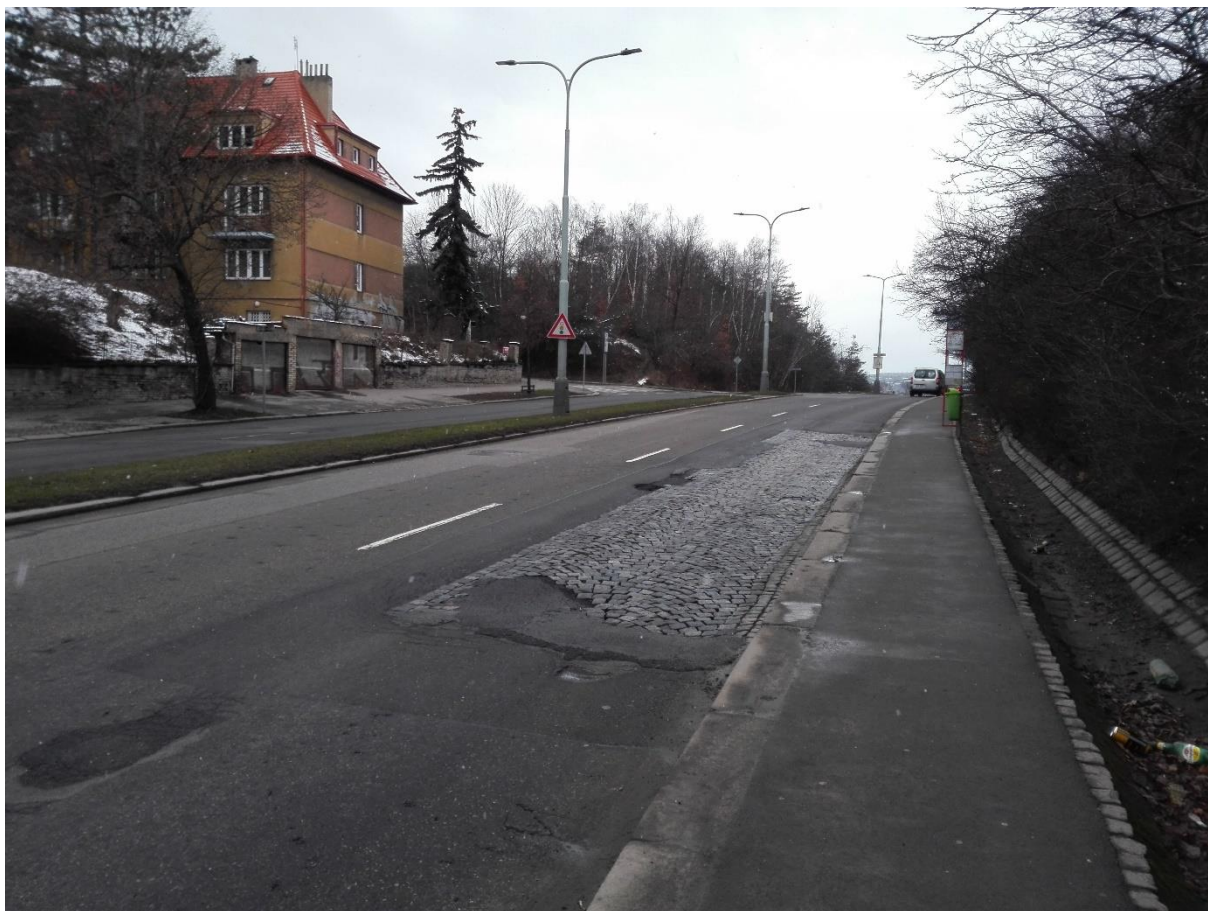
1-17 Značně poškozená vozovka trvalými deformacemi způsobenými zastavujícími autobusy na zastávce Balkán
