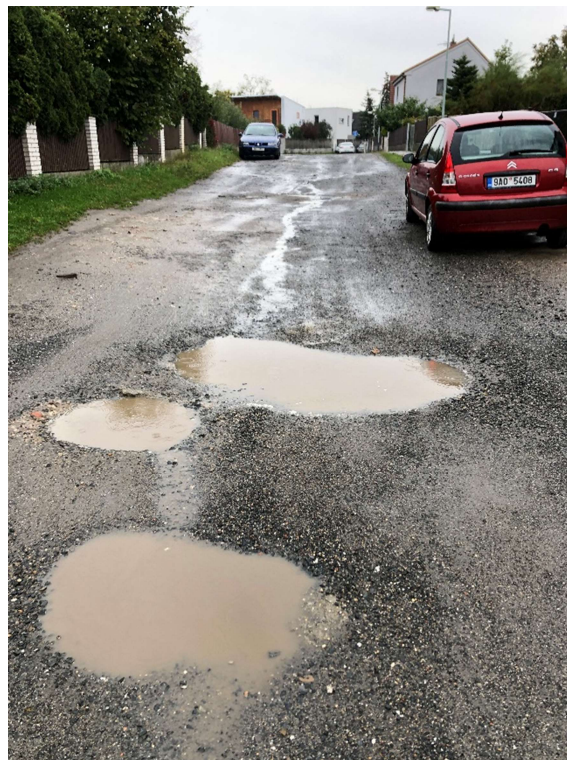
Obr. 23 – Ulice Za Pavilónem – hluboké výmoly zamezují rychlé a bezpečné odvedení dešťových vod mimo vozovku
