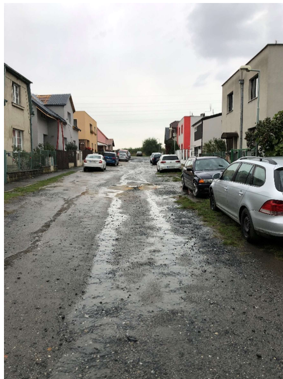
Obr. 28 – Ulice U Pavilónu – stav vozovky po dešti
