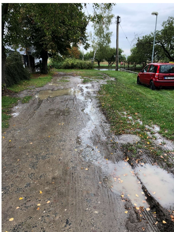
Obr. 3 – Ulice Na Horkách – stav vozovky po dešti, pohled na KÚ
