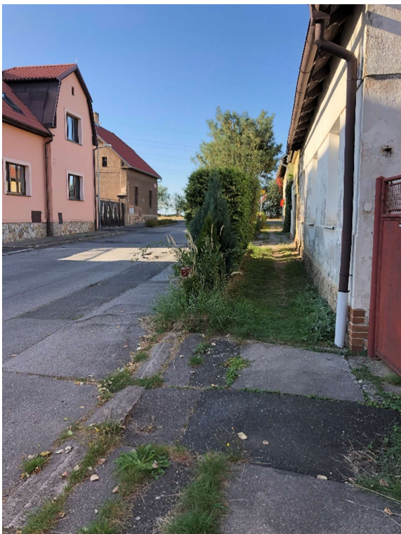
Obr. 33 – Ulice Štramberská – stav chodníku na pravé straně ve směru staničení
