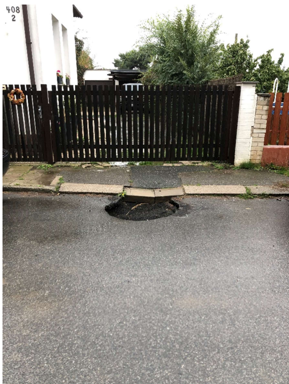
Obr. 19 – Ulice Za Pavilónem – špatný stav konstrukčních vrstev vozovky – lokální propad
