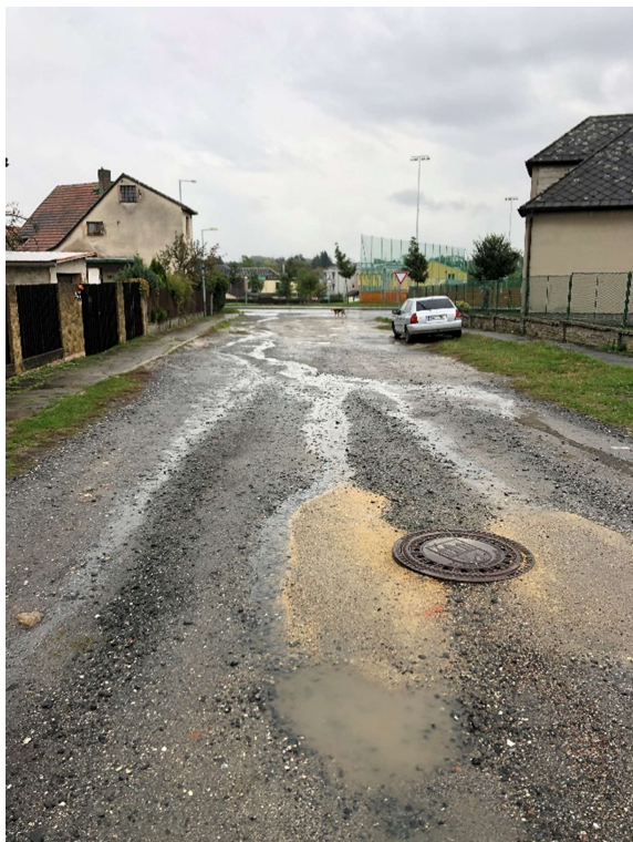
Obr. 27 – Ulice U Pavilónu – stav vozovky
