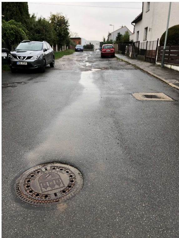
Obr. 22 – Ulice Za Pavilónem – odvodnění vozovky ovlivněné mnoha poruchami
