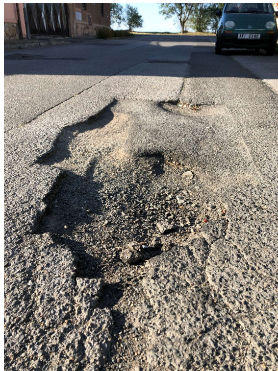
Obr. 37 – Ulice Štramberská – stav vozovky v místě jízdního pásu
