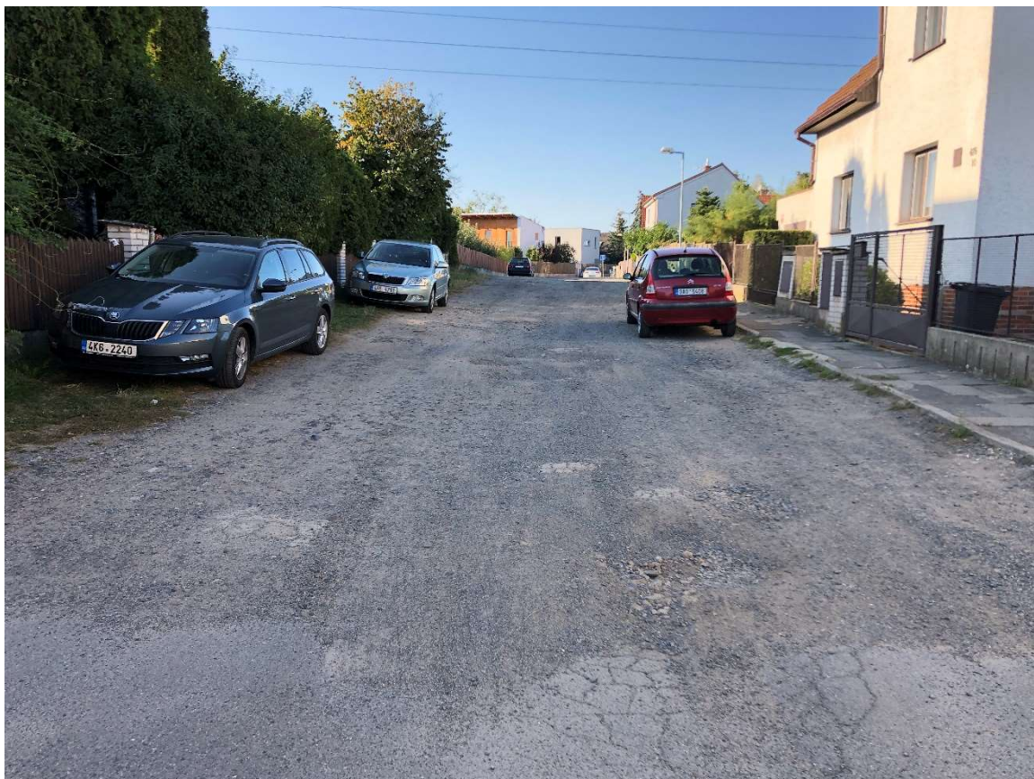
Obr. 12 – Ulice Za Pavilónem – pohled na oblast s mnoha výtluky
