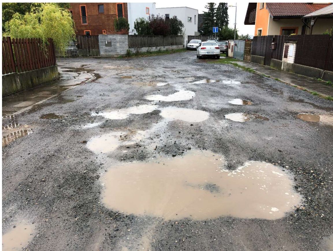
Obr. 18 – Ulice Za Pavilónem – stav vozovky u křižovatky U Staré skládky s mnoha výmoly zamezuje bezpečnému odvedení srážkových vod
