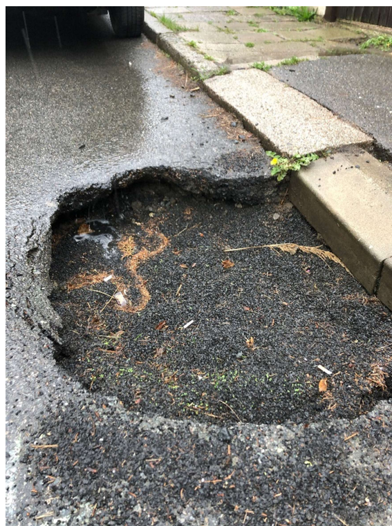
Obr. 20 – Ulice Za Pavilónem – detail propadu vozovky v místě vjezdu na pozemek
