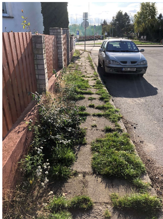
Obr. 16 – Ulice Za Pavilónem – stav chodníků – pohled k začátku staničení
