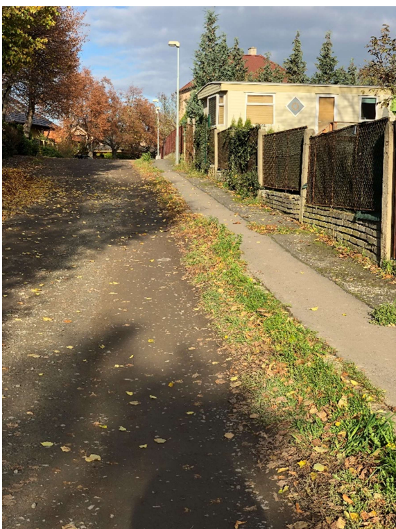
Obr. 41 – Ulice Na Horkách – styk vozovky a chodníku zarostlý plevelem
