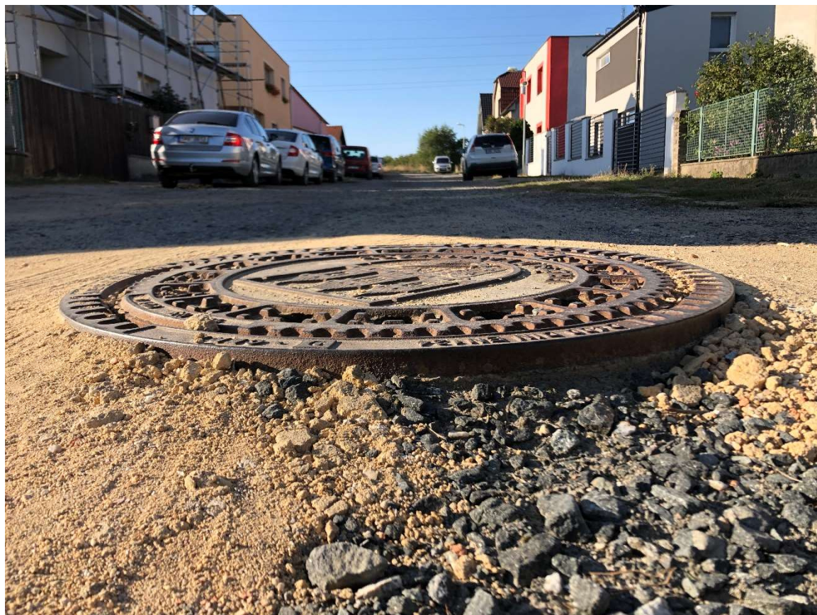
Obr. 31 – Ulice U Pavilónu – pokles vozovky v místě poklopu kanalizace
