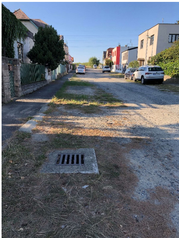
Obr. 29 – Ulice U Pavilónu – pokles vozovky vzhledem k uliční vpusť
