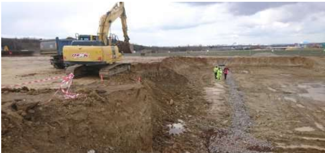
Obrázek č. 11: Zemní práce – hloubení stavební jámy a páska vyznačující její hranu [autor]
