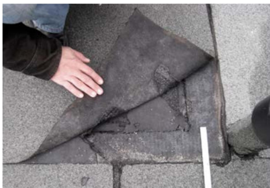
Obr. 12: Porucha střešního pláště (převzato z [3])
