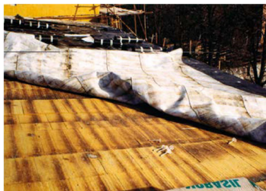
Obr. 13: Porucha střešního pláště (převzato z [3])
