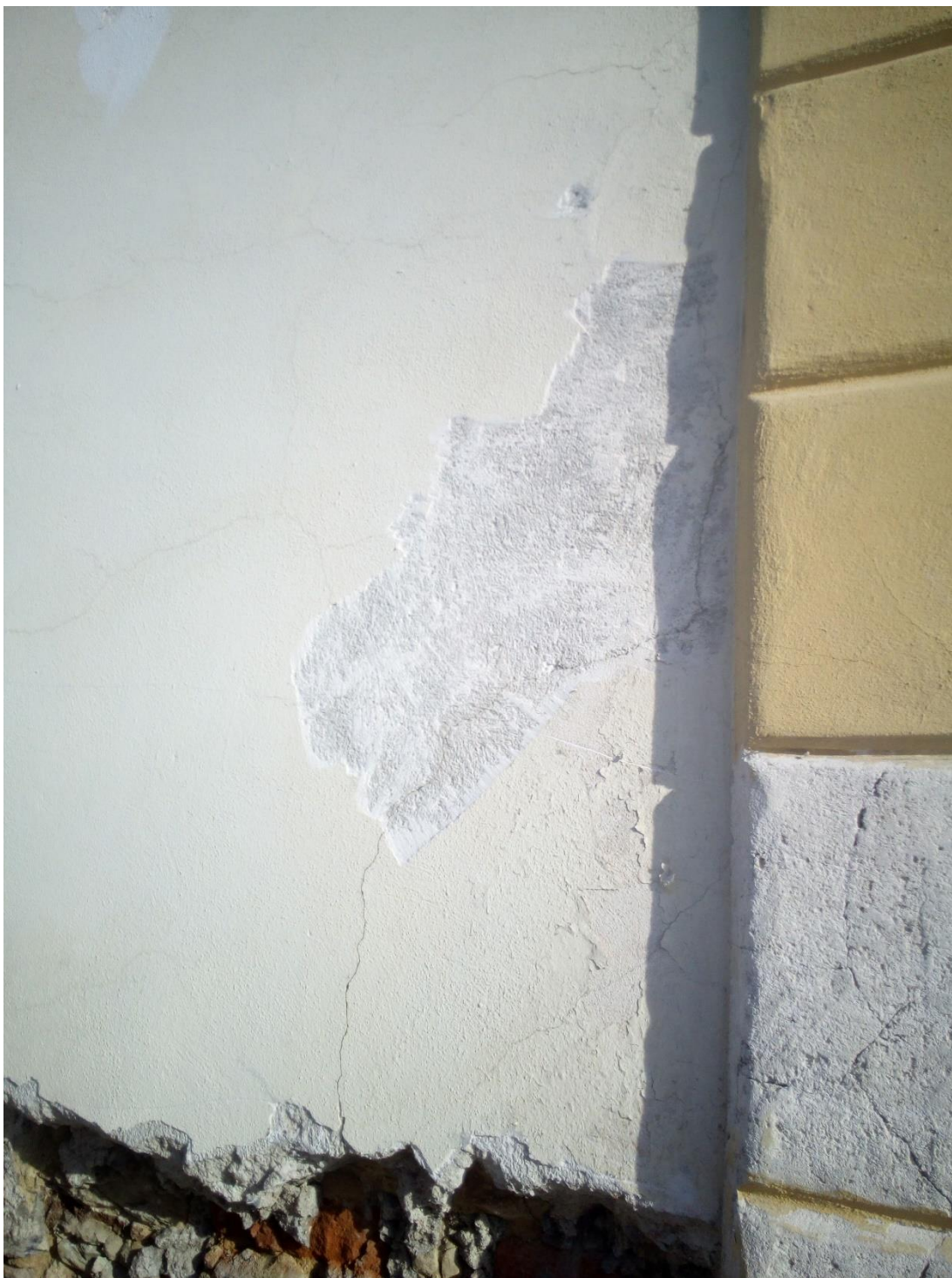
Obr. 41 – Jižní konec západní strany s viditelnými trhlinami v nepoddajné cementové vrstvě, podzim 2020. (zdroj: vlastní zpracování)
