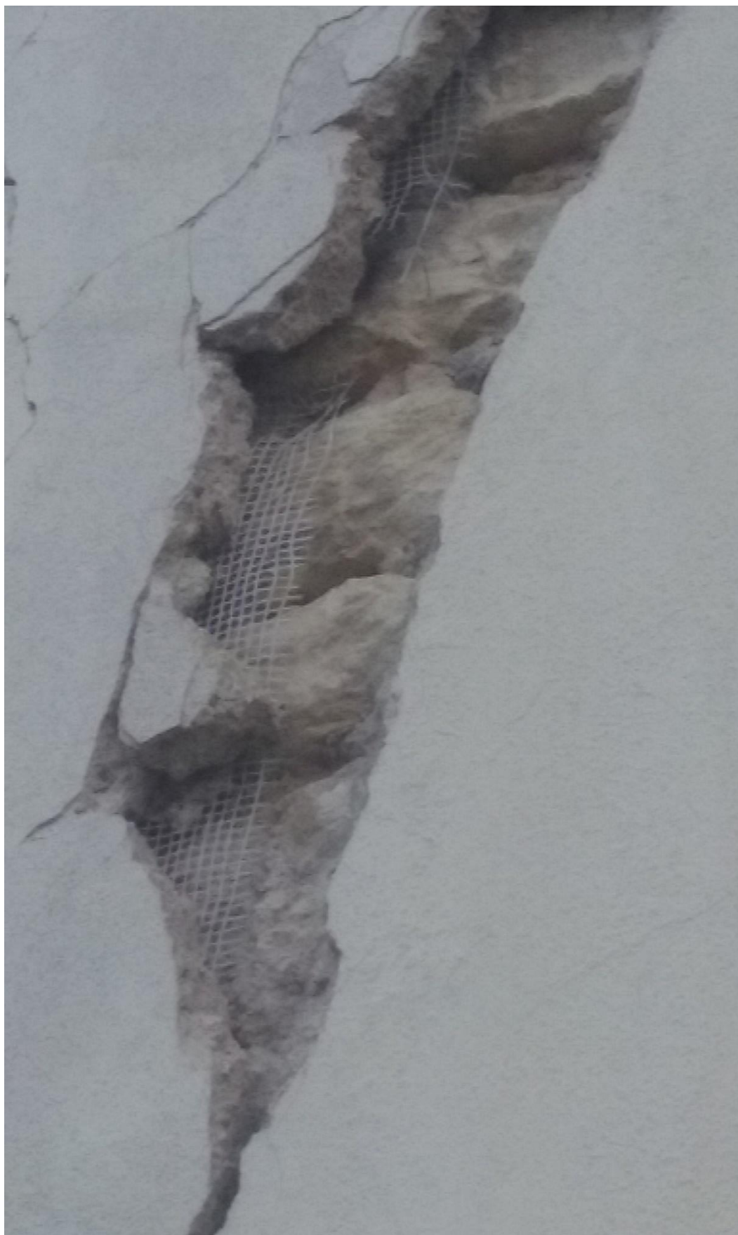
Obr. 63 – Detail nevhodné opravy výztužnou tkaninou trhliny na západní stěně, podzim 2019. (zdroj: vlastní zpracování)
