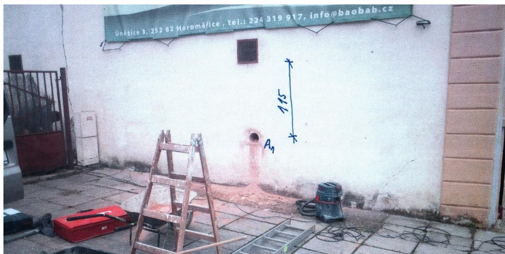
Obr. 47 – Umístění vývrtu pro vzorky A11 až A15, jižní konec západní strany, podzim 2020. (zdroj: vlastní zpracování)
