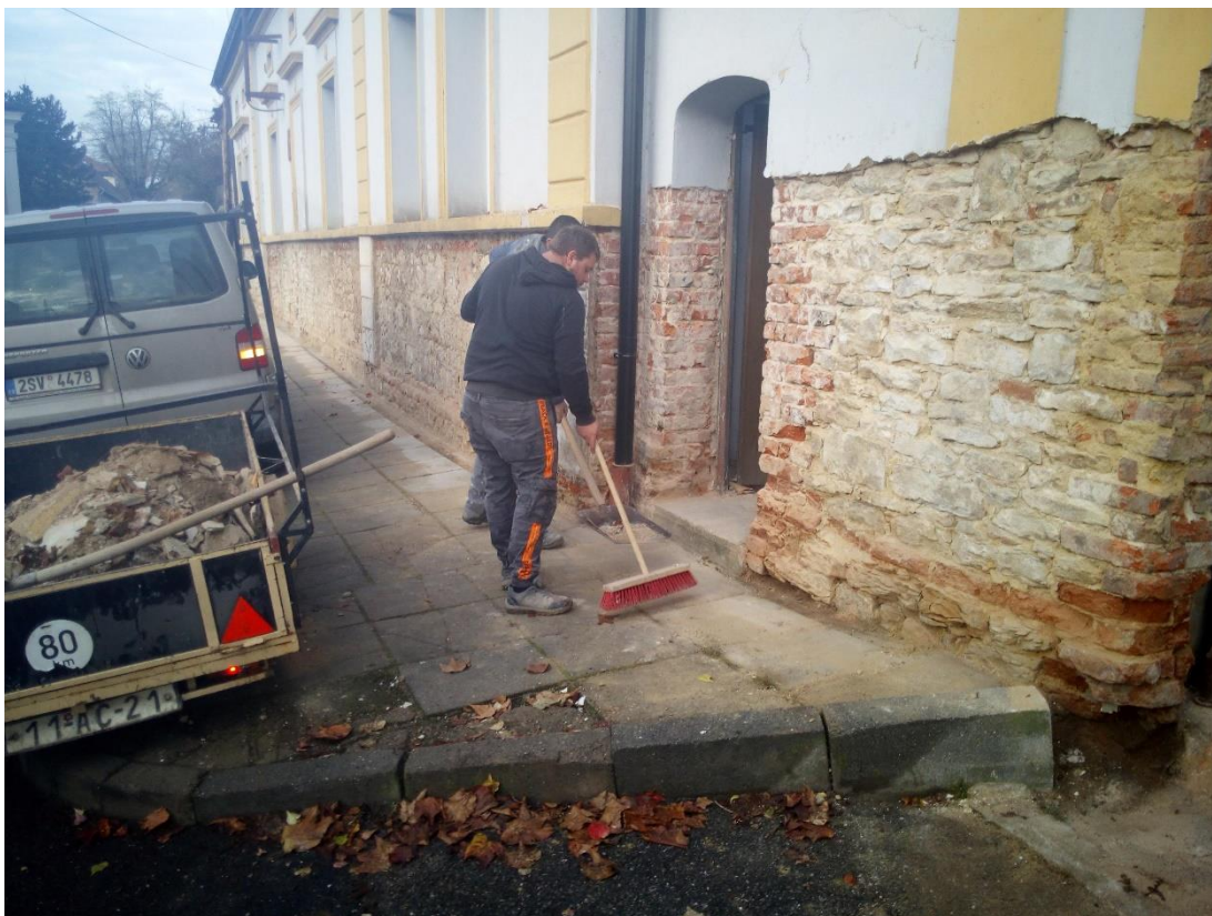
Obr. 57 – Úklid při odstranění omítek u vchodu do objektu, podzim 2020. (zdroj: vlastní zpracování)
