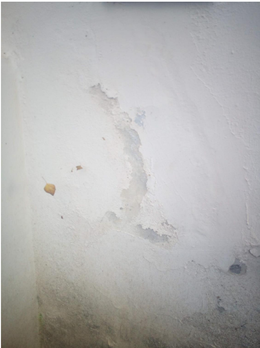
Obr. 16 – Detail degradované omítky na severní stěně školy z Obr. 15, podzim 2020. (zdroj: vlastní zpracování)
