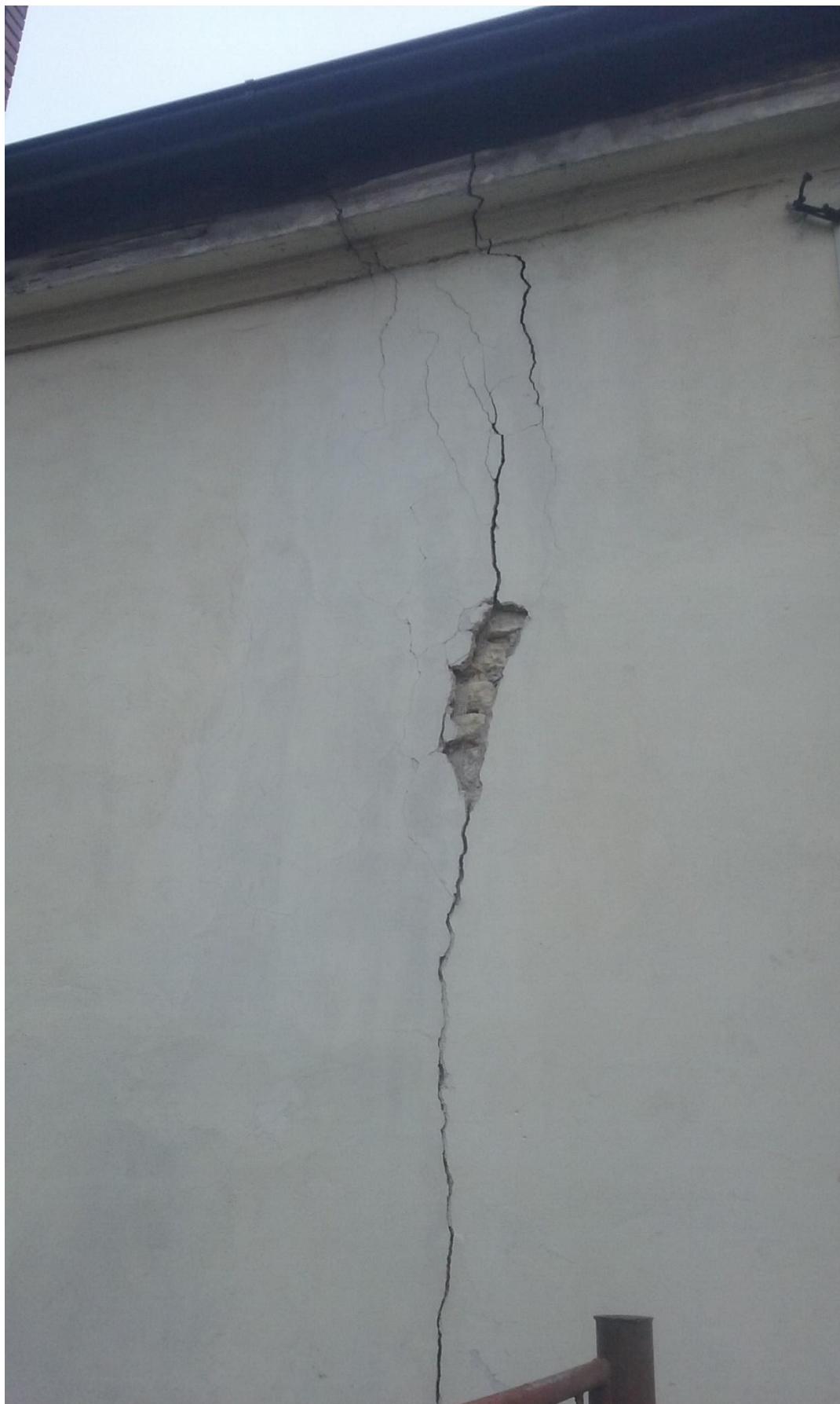
Obr. 62 – Svislá trhлина na západní stěně, podzim 2019. (zdroj: vlastní zpracování)
