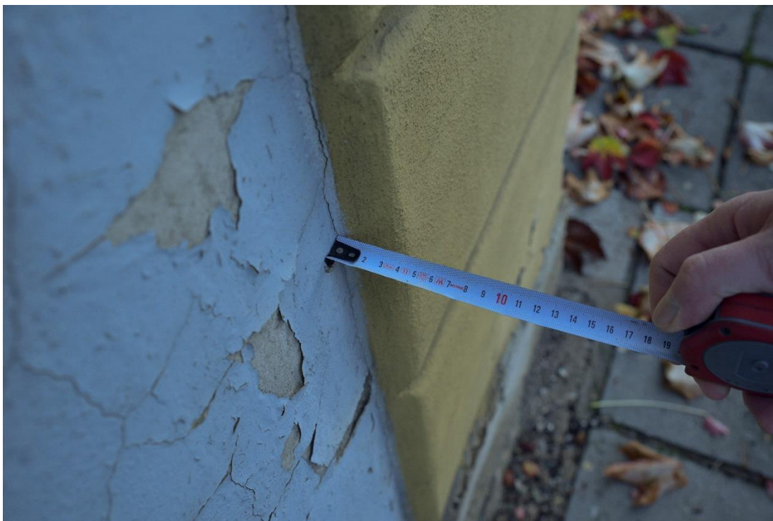
Obr. 39 – Detail degradované fasády, zejména nevhodného nátěru, podzim 2020. (zdroj: vlastní zpracování)
