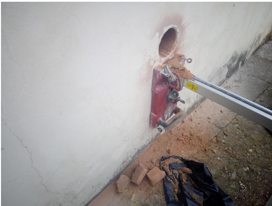
Obr. 51 – Provedený jádrový vývrt \varnothing 152 mm, podzim 2020. (zdroj: vlastní zpracování)
