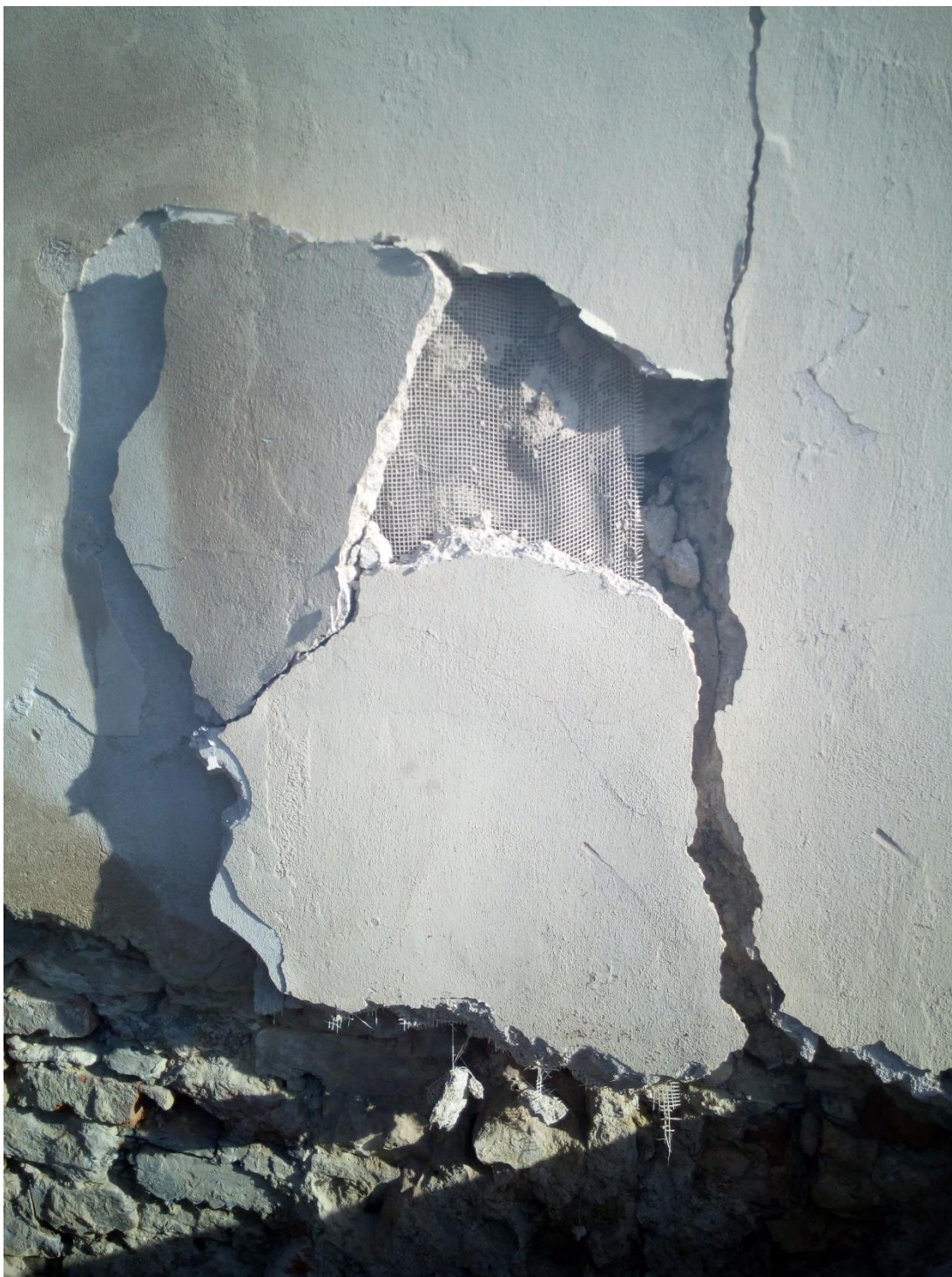
Obr. 59 – Odstraňování velmi degradované chybné omítky přes trhlinu na západní straně, podzim 2020. (zdroj: vlastní zpracování)
