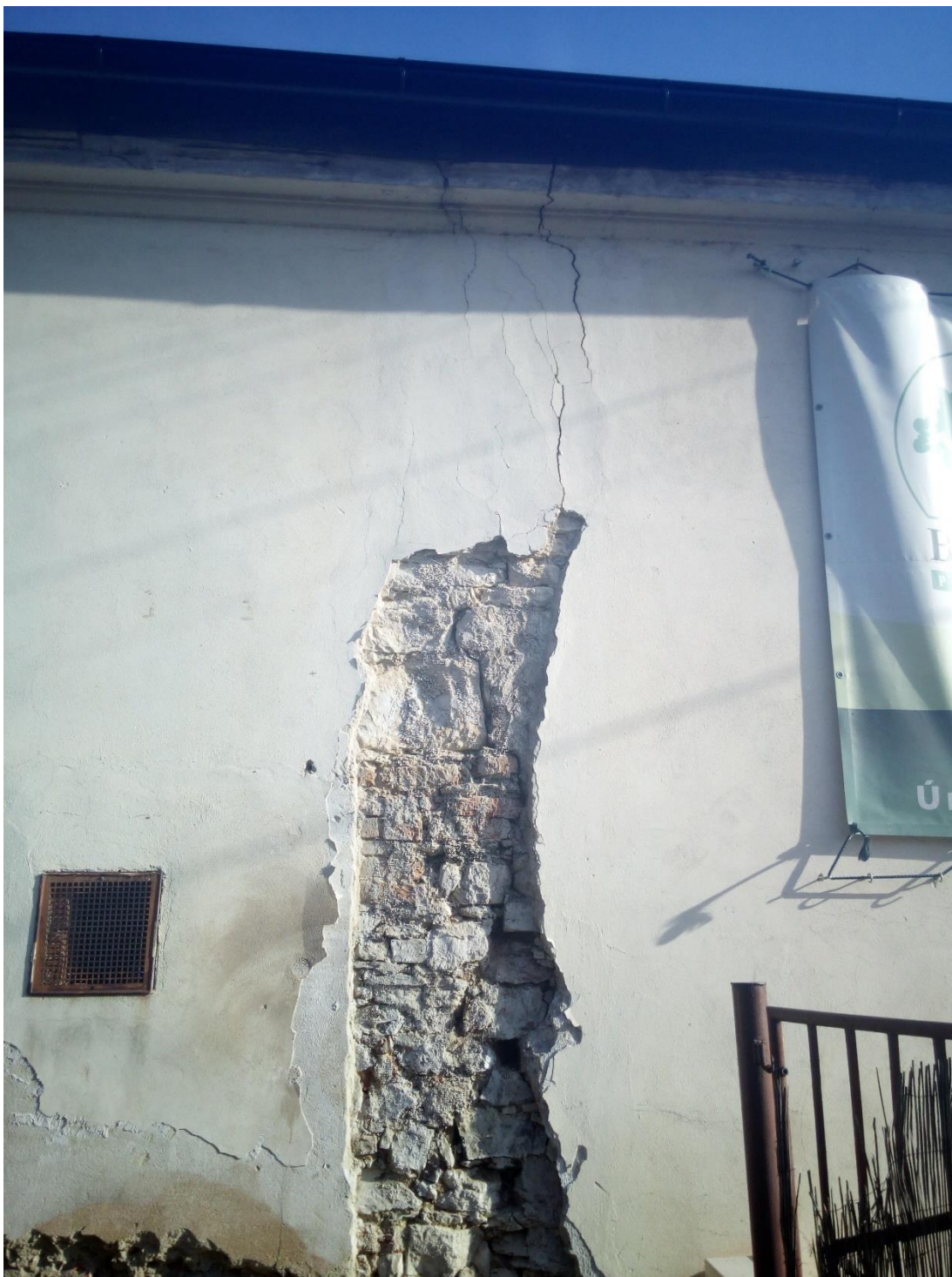
Obr. 64 – Odpadlá omítka vinou nevhodné opravy výztužnou tkaninou trhliny na západní stěně, podzim 2020. (zdroj: vlastní zpracování)
