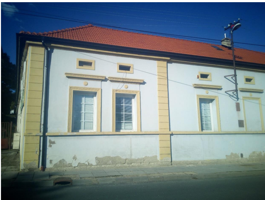
Obr. 38 – Západní část jižního průčelí s degradovanou fasádou a nevhodným odstínem krycího nátěru, podzim 2020. (zdroj: vlastní zpracování)
