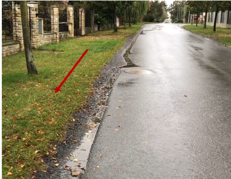
Obrázek 23: koncentrace povrchového odtoku při okraji vozovky v ul. K Rukavičkárně v úseku mezi křižovatkami ul. Výravská a Všešarská (šipka znázorňuje směr odtoku) (foto autor)
