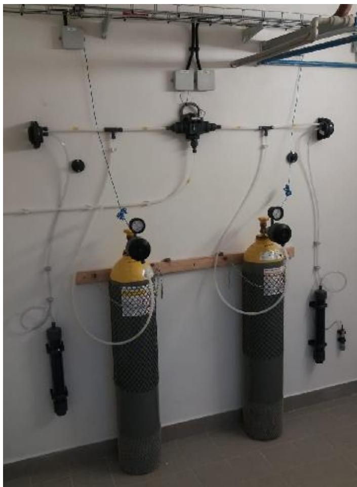
Obr. č. 10 Dávkování plynného chloru
