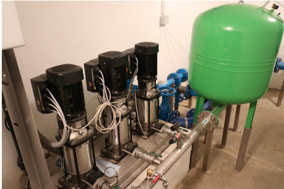
Obr. č. 23 ATS stanice ve vodojemu Filka
