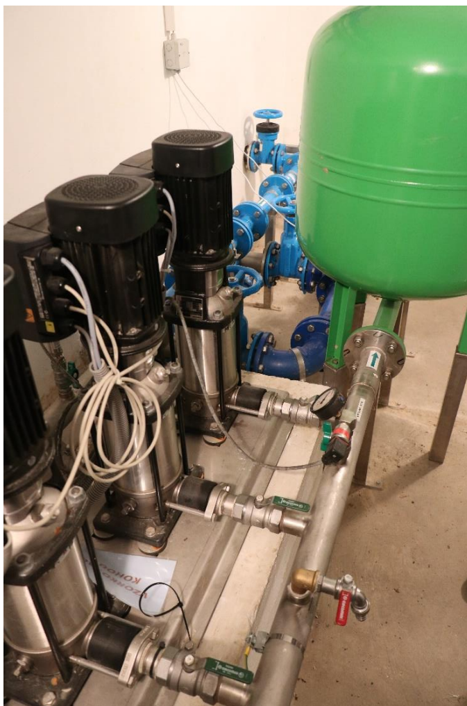
Obr. č. 49 Vystrojení čerpací stanice ve vodojemu Filka
