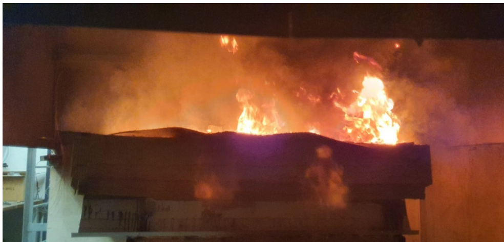
Obr. 71: prohoření manžety, plameny vyšlehávají ze střešní vpusti (viditelné zvlnění je podkladní sklovláknitá textilie, hydroizolační vrstva byla pnutá)
