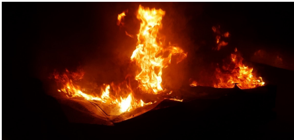
Obr. 72: důsledek hoření hořlavé tepelné izolace, hydroizolační plášt' v plamenech
