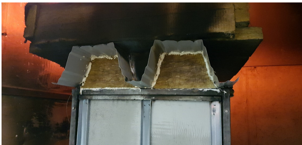
Obr. 70: vypadlá ucpávka z minerální vlny, která byla umístěna v místě uložení na zkušebním zařízení
