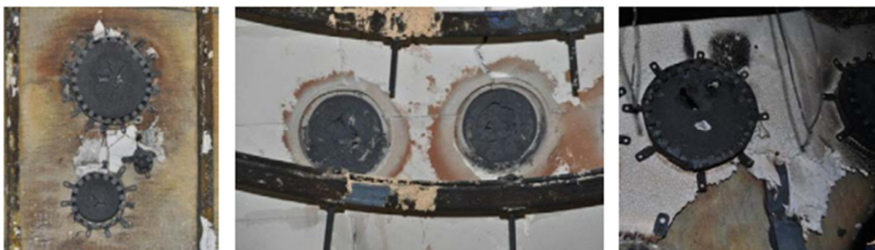
Obr. 13: Intumescentní pásek a protipožární manžeta vystavená účinkům požáru (stav po zkoušce) [14]
