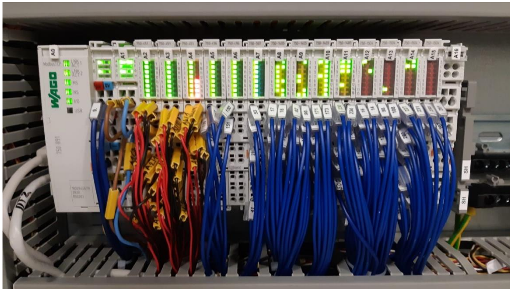
Obrázek 15: Vstupně/výstupní modul od firmy Wago na střední škole v Písku
