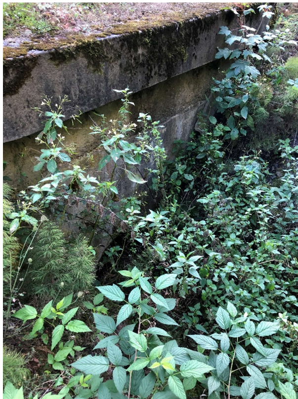
Obrázek 16: Zarostlý trubní propustek v km 51,476
