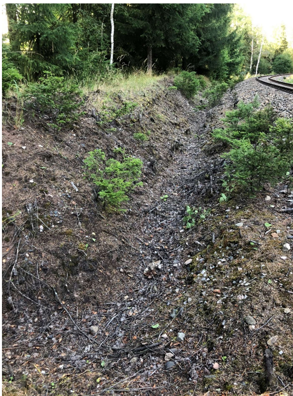
Obrázek 33: Zanesený nezpevněný příkop ve směrovém oblouku č. 6
