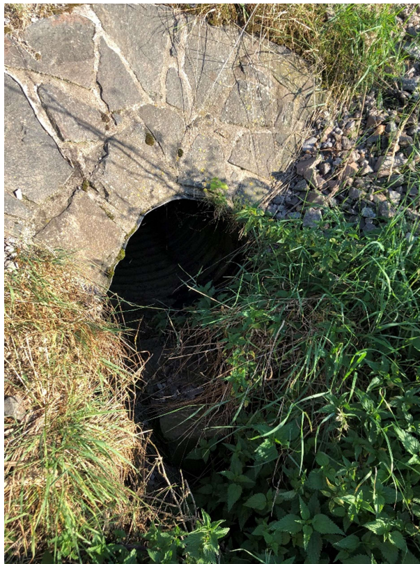
Obrázek 10: Zarostlý trubní propustek v km 50,203
