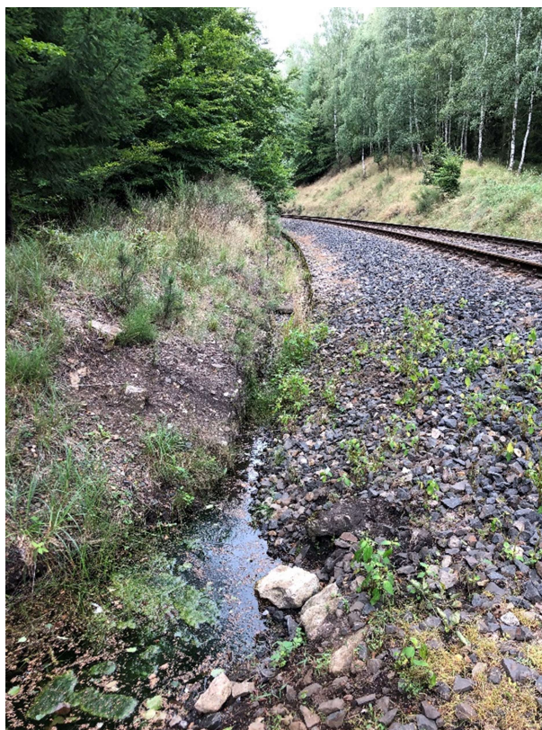
Obrázek 36: Zanesený zpevněný příkop ve směrovém oblouku č. 7
