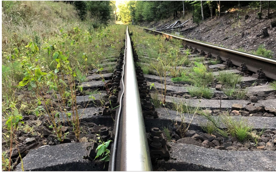
Obrázek 19: Vnější ojetí kolejnice v přímém úseku
