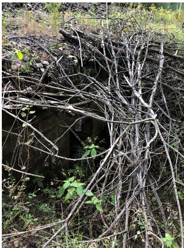
Obrázek 18: Zanesený deskový propustek v km 51,951
