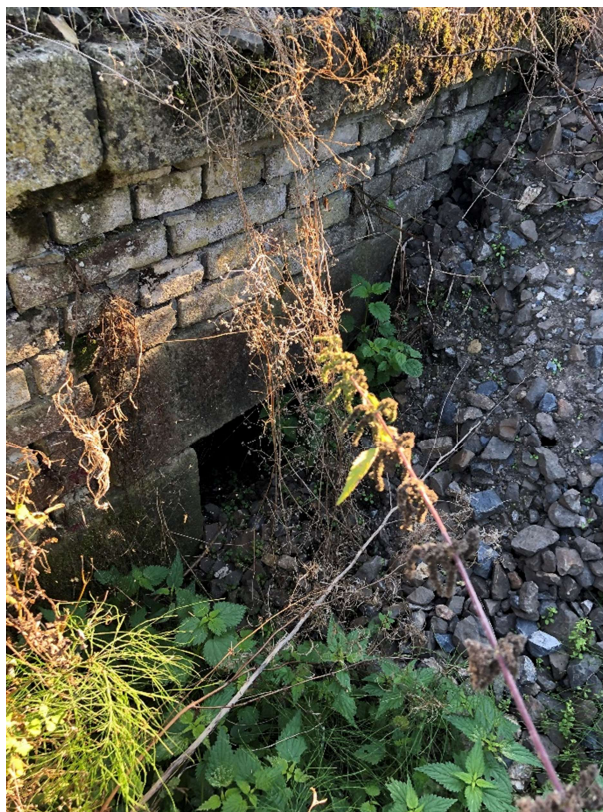
Obrázek 11: Zanesený deskový propustek v km 50,575
