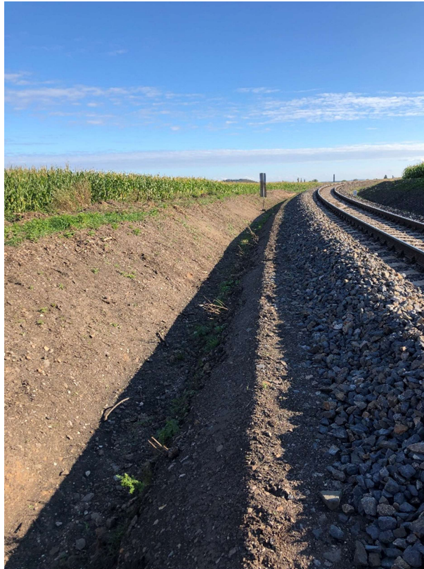
Obrázek 9: Čistý nezpevněný příkop ve směrovém oblouku č. 2
