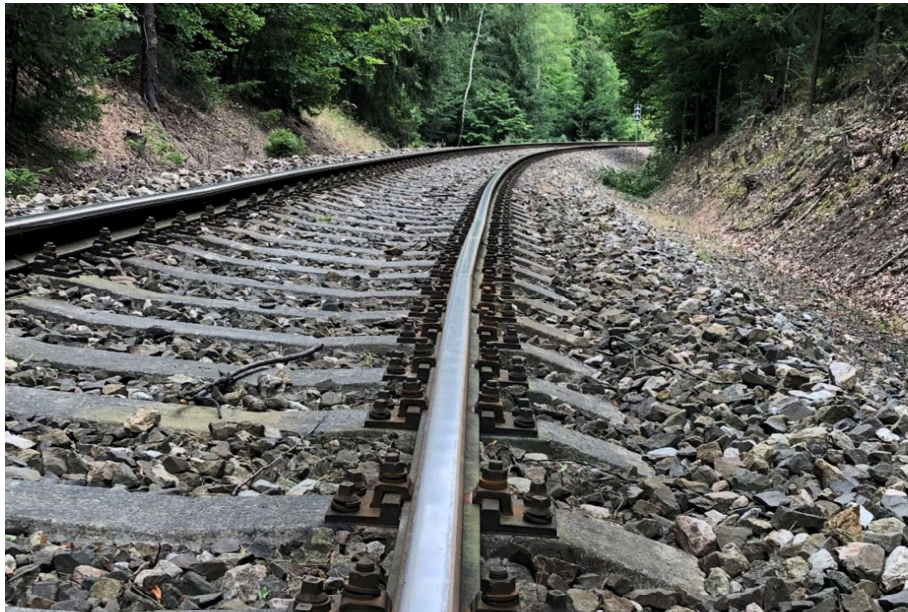
Obrázek 41: Vnější ojetí na levém kolejovém pásu v oblouku č. 8 (pohled proti směru staničení)
