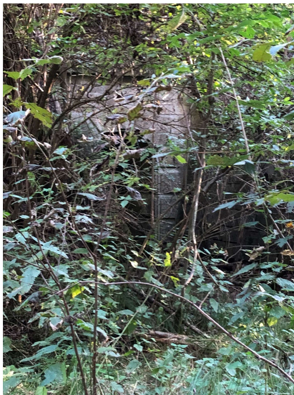
Obrázek 21: Zarostlý klenutý propustek v km 52,739
