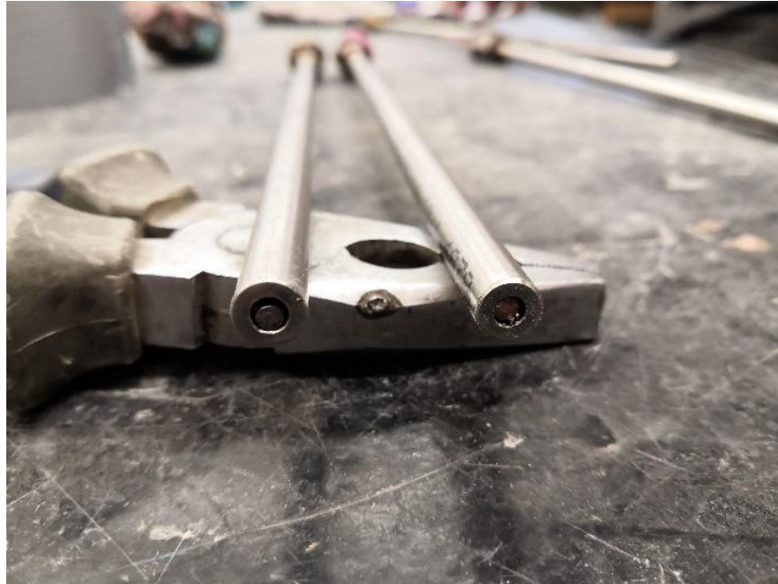
obr. 23 - Ocelová tyč utěšňující otvor trubky proti případnému vniknutí betonové směsi při betonáži
