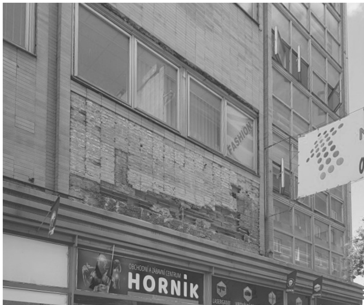
obr. 32 - Detail rozpadající se fasády z roku 2019.
