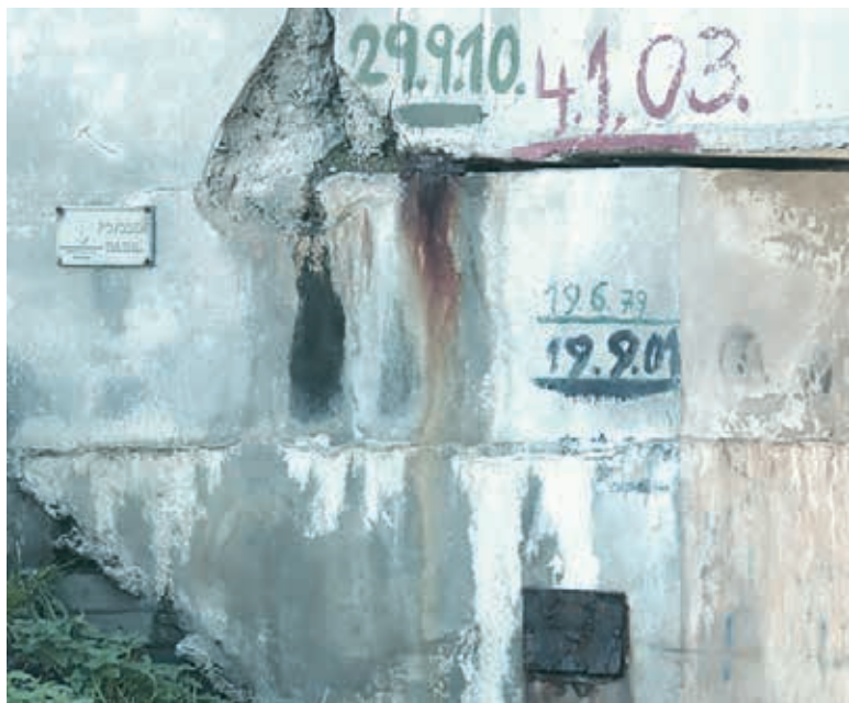
Obr. 8. Značky povodní Mrliny v letech 1979, 2001, 2003, 2006 a 2010 na pravobřežním návodním pilíři mostu v Rašovicích (nápis na spodní desce je nečitelný); chybí značka povodně z června 2013
