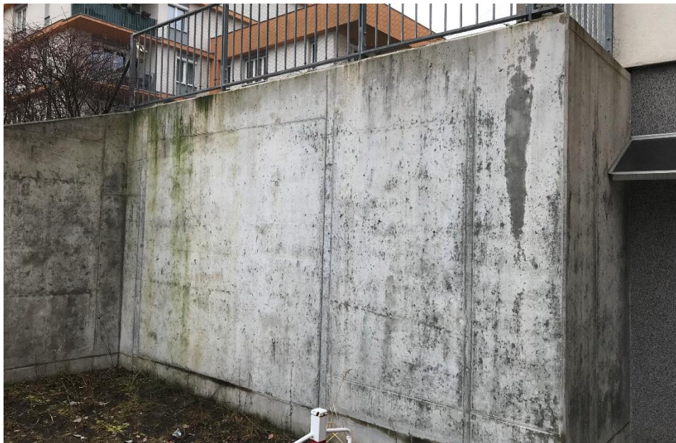
Obr. 97 Příklad opěrné stěny s nevzhledným povrchem. Stěna byla vybetonována v roce 2009. Fotoarchiv autora.
