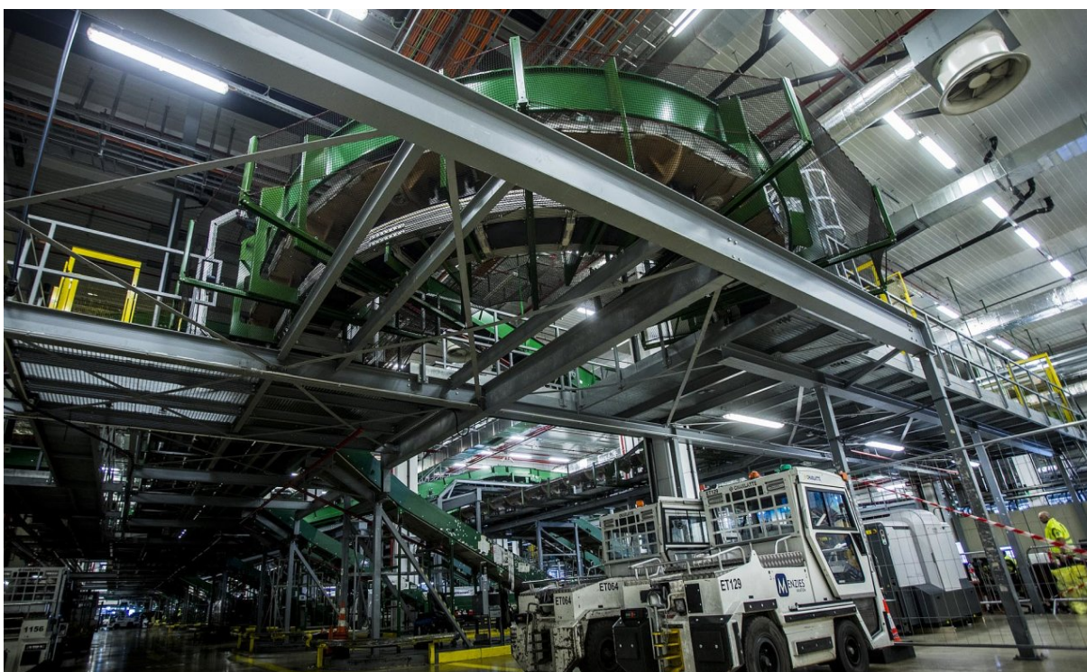
Obrázek 12: Třídírna zavazadel Letiště Praha. Zdroj:[23]
