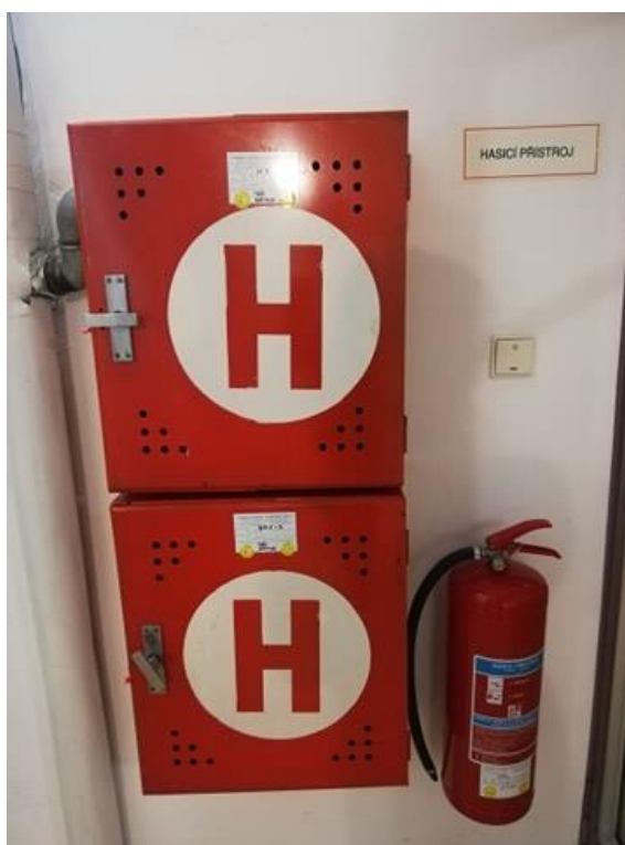
Obrázek 18 — Hydrantové skříně [autor]
