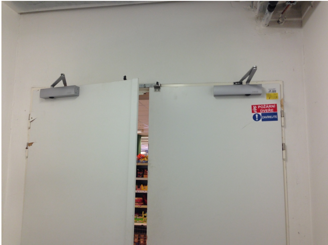
Obrázek 8 - Poškozený požární uzávěr [zdroj vlastní]
