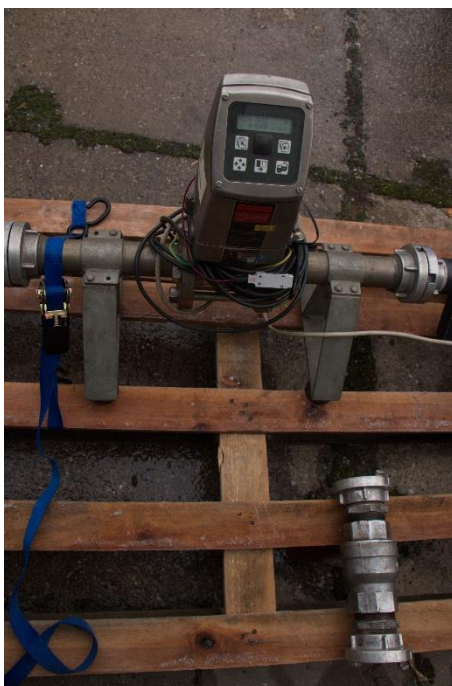
Obrázek 34 - Instalace průtokoměru [zdroj autor].
