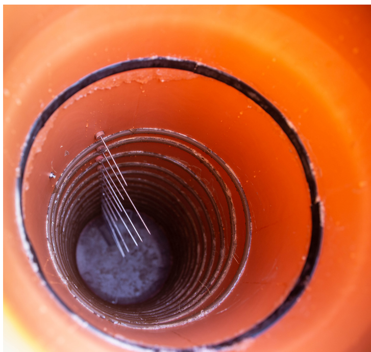
Obr. 2.9: Neprodyšné pryžové bariéry v potrubí. Fotografie: Michal Fanta.
