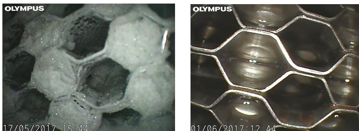
Obr. 36 Defektoskopický snímek zaneseného výměníku před chemickým čištěním (vlevo) a výměníku po chemickém čištění (vpravo) [8A, 9A].
