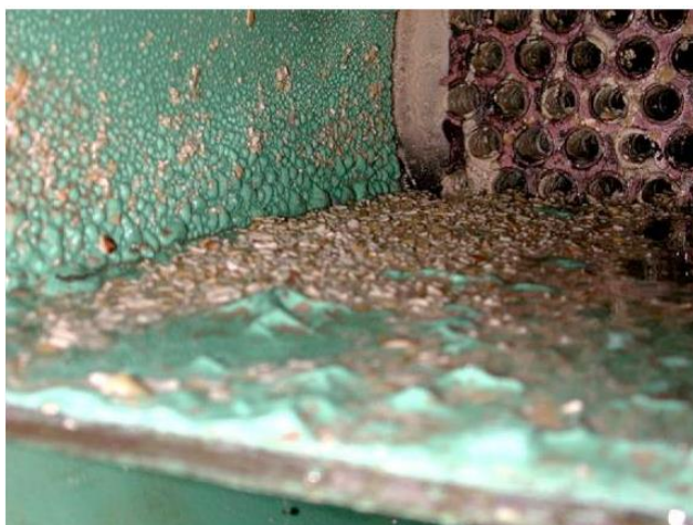
Obr. 3 Kotelní kámen (uhličitan vápníku a hořčíku) vytvořený uvnitř tepelného výměníku s chladicí vodou po 4 letech provozu [10].
