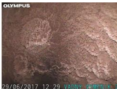
Obr. 33 Endoskopický snímek nejzanesenějšího místa vstupu primární strany výměníku [7A].
