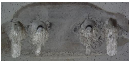
Obr. 36: Typické porušení řad K10 a K11 usmyknutím spřahovacích trnů v oblasti nad svarem
