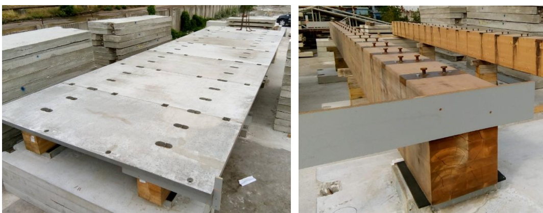
Obr. 72: Vlevo zkušební uložení panelů na trámy před instalací spřahovacích prvků, vpravo osazené spřahovací prvky do kapes na trámech
