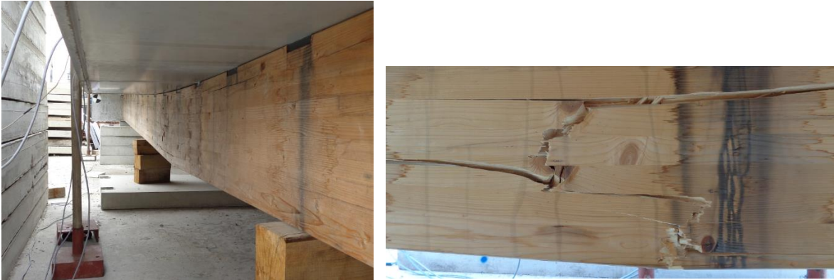
Obr. 81: Vlevo pohled na lávku s porušeným dřevěným trámem uprostřed rozpětí, vpravo detail tahového porušení ve spodu dřevěného trámu
