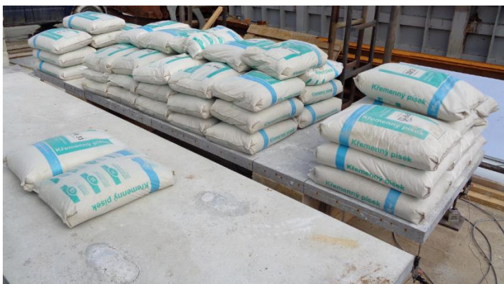
Obr. 85: Simulace charakteristického zatížení chodce 5 kN/m 2 na konzolách a v poli pomocí pytlů s pískem
