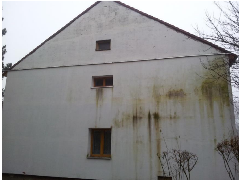
Obr. 3 Severozápadní fasáda bytového domu v Litvínově s výskytem biofilmu tvořeným plísněmi, řasami a bakteriemi
