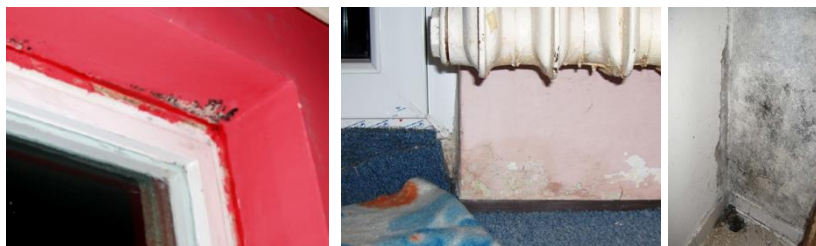
Obr. 1 Problematická místa s výskytem plísní v bytovém domě
