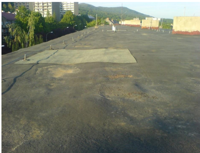
Obr. 7 Pohled na zdegradovaný povrch ploché střechy s asfaltovými pásy, bytový dům v Litvínově
