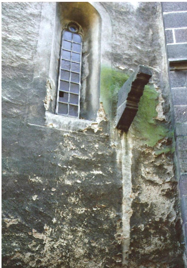
Obr. 2 Biodegradace gotické omítky kostela sv. Jakuba v Prachaticích v místě konzoly, která při dešti vytváří podmínky pro rozstříkávání vody a tím optimální podmínky pro růst mechů, řas a lišejníků. Okolní plochy vykazují známky značného stupně odvápnění (Jiří Hošek)
